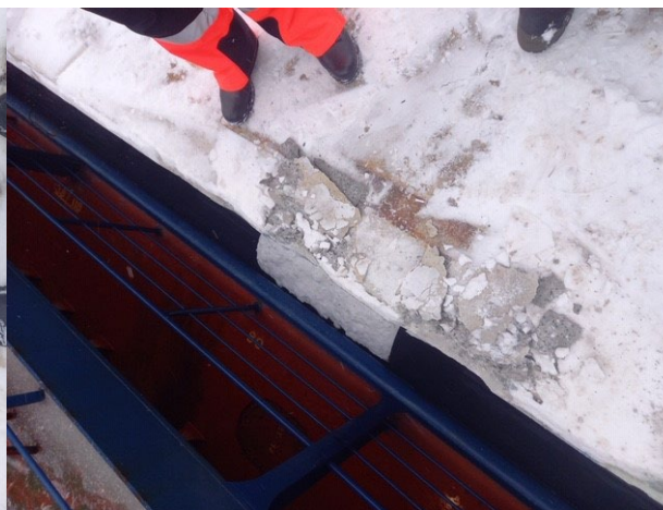
Foto3 Kai betoonserva ülemise ääre vigastused
