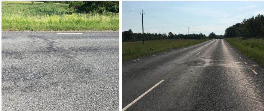
Fotod 2.3 ja 2.4. km 0.37 olev põikpragu. Km 0.86 ja 0.90 on tee keskel lapitud kohad, mille näol on tõenäoliselt tegemist altpoolt üles pressiva vee tõttu tekkinud lokaalse kandevõimekaotusega.
