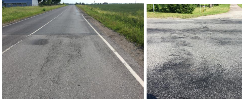
Fotod 2.1 ja 2.2. Teelõigule eelnev asfalteeritud ristmiku osa on deformeerunud. Km 0.22 asuv põikpragu.
