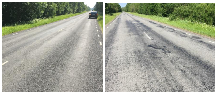
Fotod 2.7 ja 2.8. Vahemikus km 2.9...3.5 esinevad mitmed serva defektid, piki- ja põikpraod.
