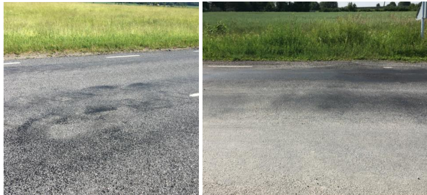
Fotod 2.11 ja 2.12. Defektid vahemikus km 5.2...5.9.
