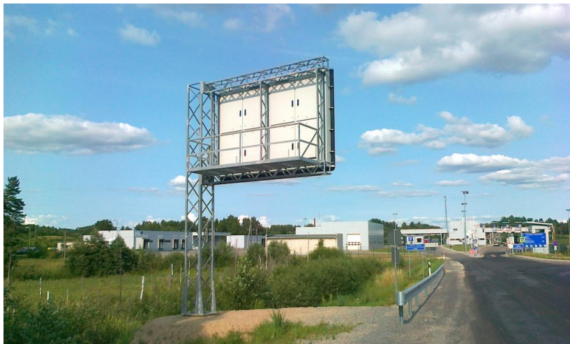
Joonis 3.11 Luhamaa VMS märgi kandekonstruktsioon
