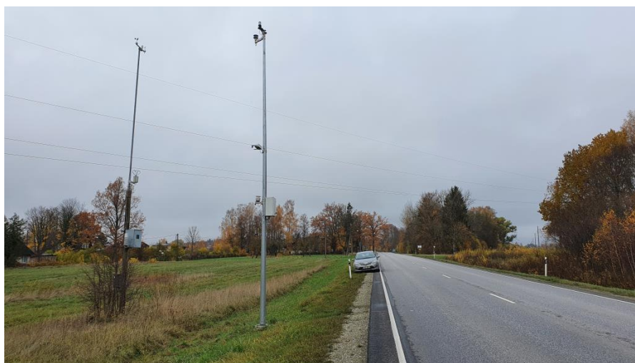
Joonis 3.1 Vana ja uus Rõngu teeilmajaam 10 m koonusmastil
