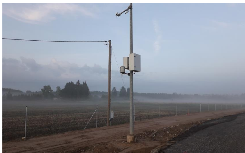
Joonis 3.4 Pikknurme teeilmajaam ja loenduspunkt samal mastil
