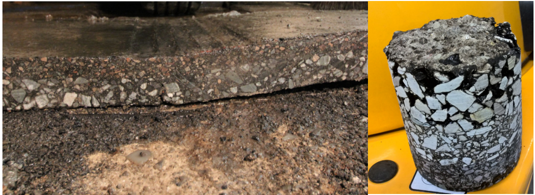
Joonised 3.48 ja 3.49. Tõmbepingete tõttu prao teke asfaltkatte alapinda. Stabiliseeritud proovikeha alapinnas on samamoodi peentäitematerjali ja tolmu, mis esines tasanduskihi peal.
