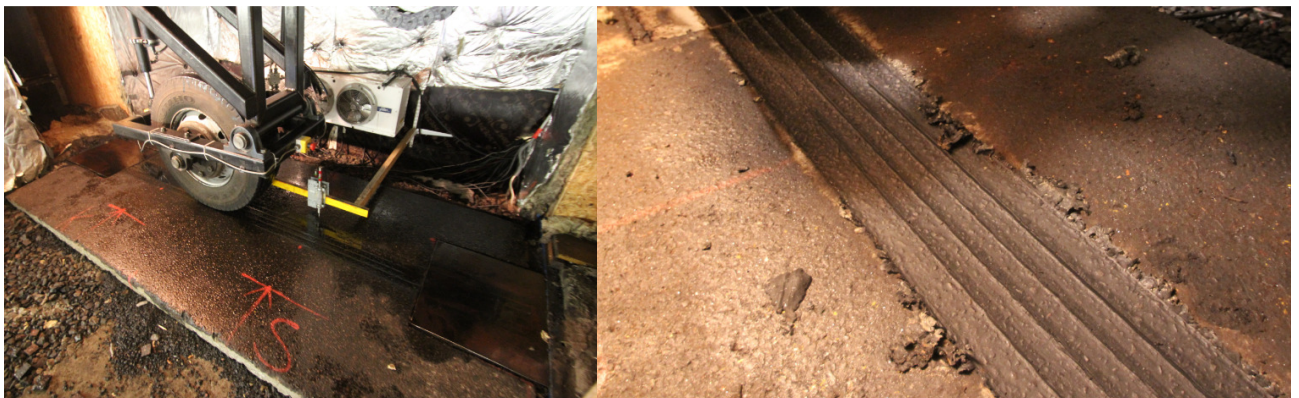
Joonised 3.35 ja 3.36. Hüdrovooliku purunemine põhjustas õli sattumise asfaltkattele, millest osa tungis ka asfaltbetooni pooridesse ja mida ratta koormus hakkas sealt uuesti välja pressima.
