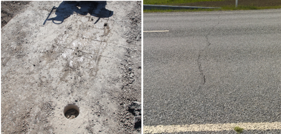
Joonised 2.11 ja 2.12. Aastal 2012 ehitatud stabiliseeritud kihist proovikehade võtmine. Teisel objektil olid iga 100 m kohta 2...3 põikpragu
