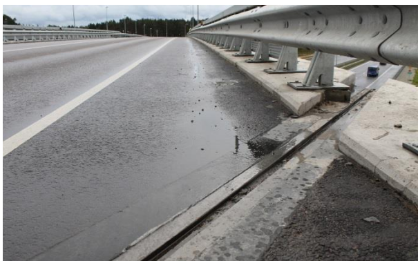
Foto 123. Luige viadukt, vesi ja sodi vuugiprofiilil
