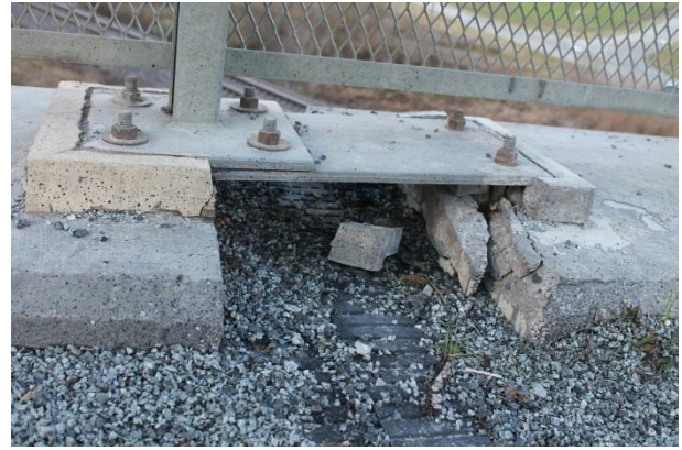
Foto 138. Kadrina viadukt, piirdeposti kinnitus
