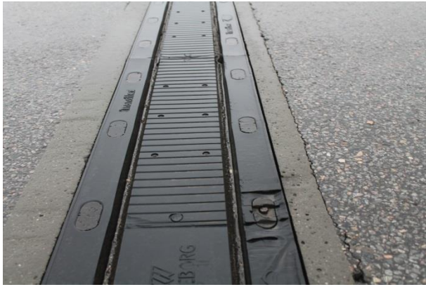
Foto 141. Kärevere III sild, sahkamiskahjustused
