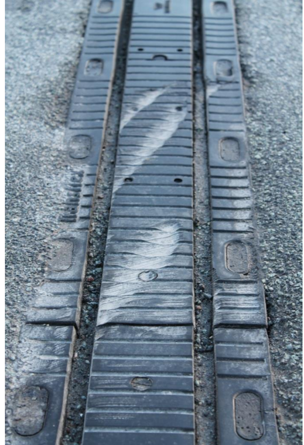
Foto 136. Kadrina viadukt, sahkamiskahjustused
