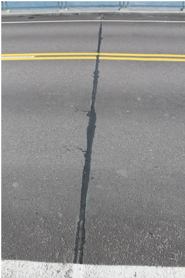
Foto 180. Asfaldivuuk vuugita sillal
