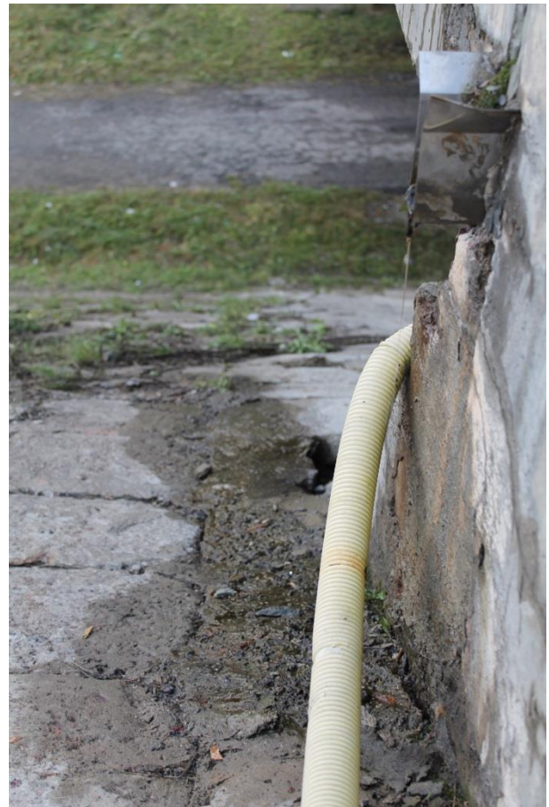
Foto 6. Ääsmäe I viadukt, vuugi renn
