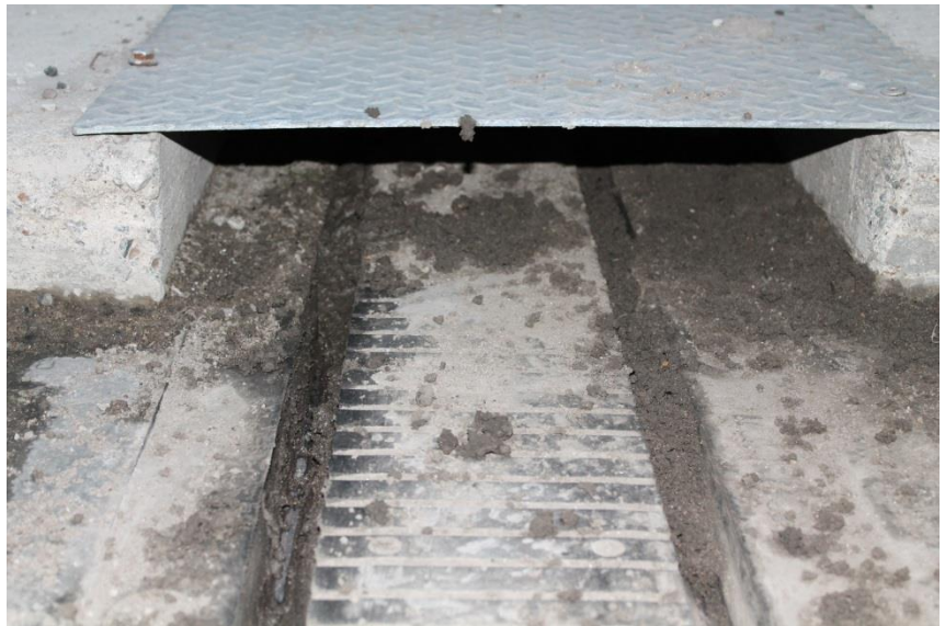
Foto 161. Kohtla-Järve viadukt, vuuk servaprussi kohal
