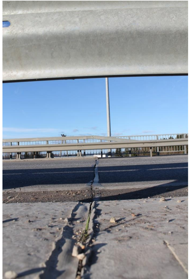
Foto 54. Sõmeru viadukt, vuugitäide
