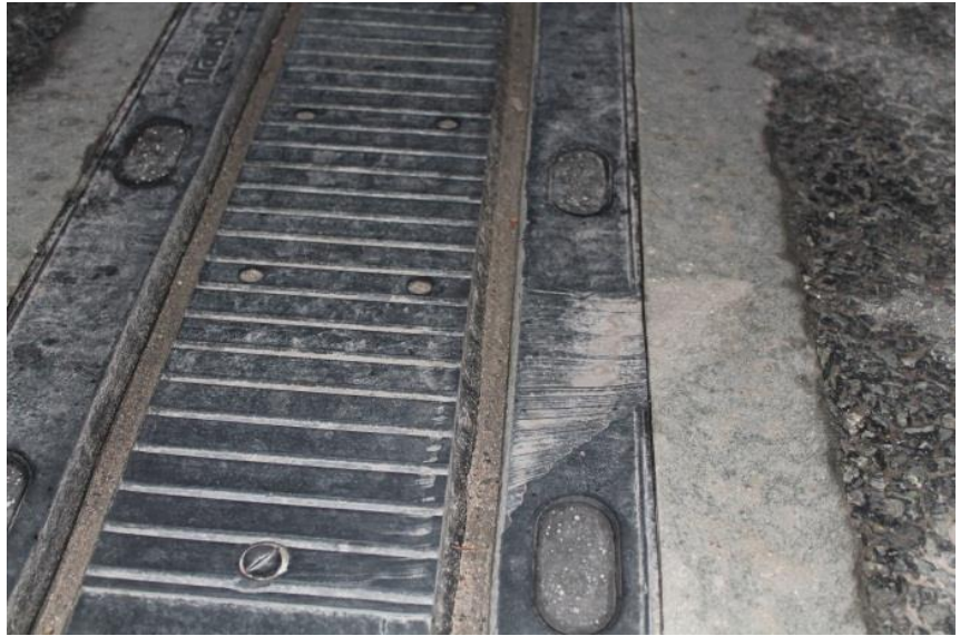
Foto 159. Kohtla-Järve viadukt, sahkamiskahjustused
