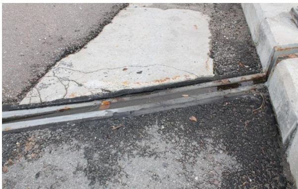
Foto 115. Kiiu I viadukt, vesi vuugiprofiilil
