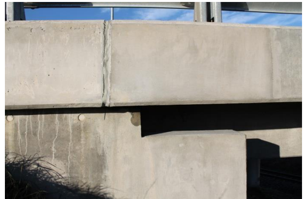
Foto 52. Sõmeru viadukt, vee läbijooks kaldasambal
