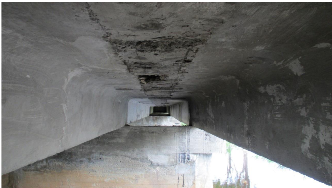
Foto 7. Taladevahelise monoliitbetooni halb kvaliteet
