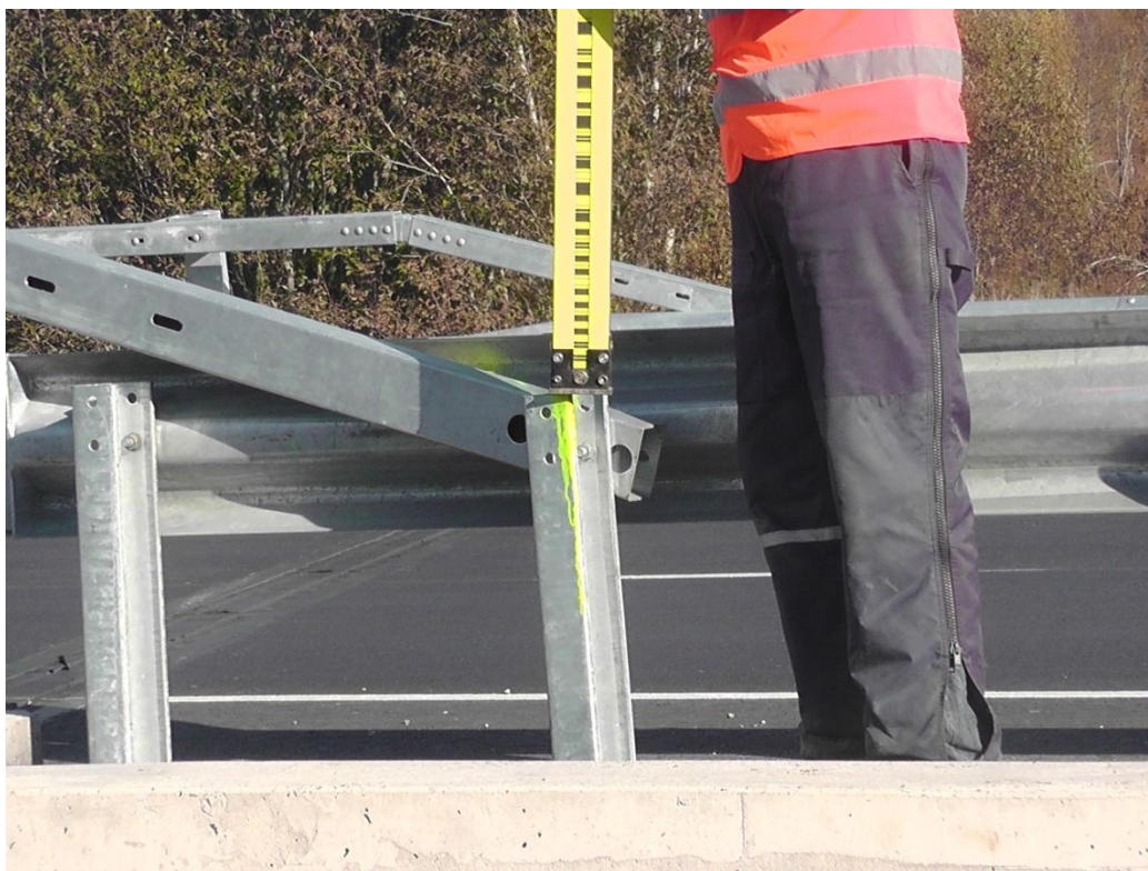
Joonis 9. Säreveere maantee silla deformatsioonide määramise ajutine reeper (kõrvaloleva uue silla piirdepost) koos sellele asetatud mõõdulatiga
