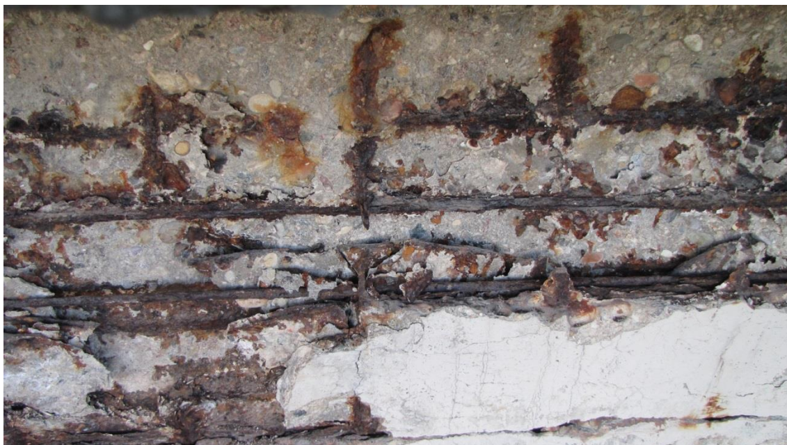
Foto 6. Keskmise ava äärmise tala (uue silla poolse) ulatuslikud korrosioonikahjustused
