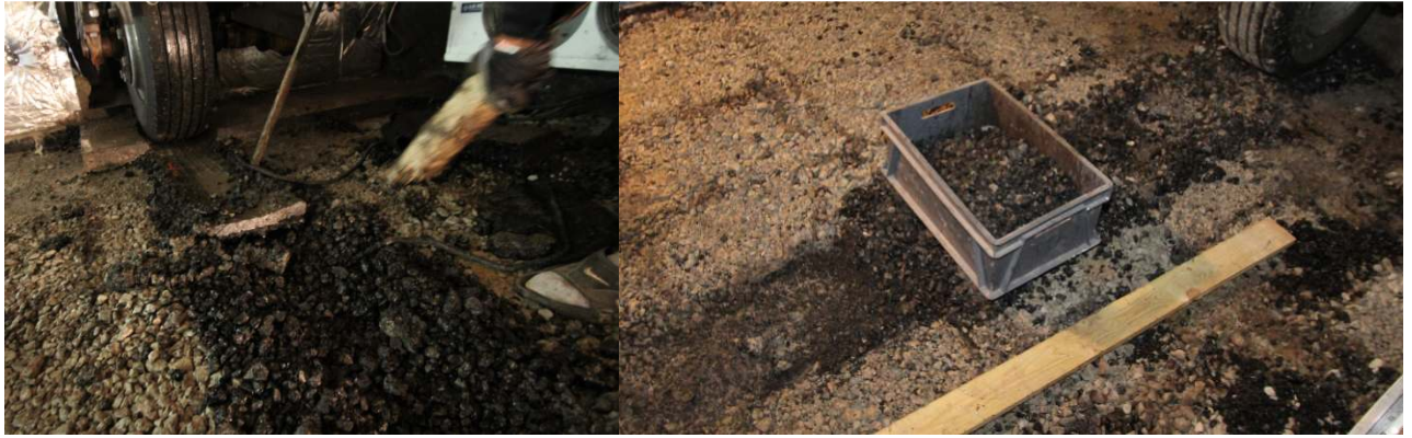
Fotod 42 ja 43. Alumine asfaltbetoon oli lagunenud ja bituumen kristalliseerunud. Autor Sven Sillamäe
