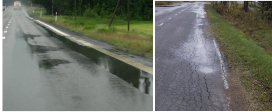
Joonised 1 ja 2. Raskeliikluse tagajärg teedevõrgule on püsivad deformatsioonid – pikiroopad ja serva deformatsioonid, mis suurendavad liiklusõnnetuste ohtu ja põhjustavad suurendatud kulutusi nii liiklejatele kui tee omanikele.
