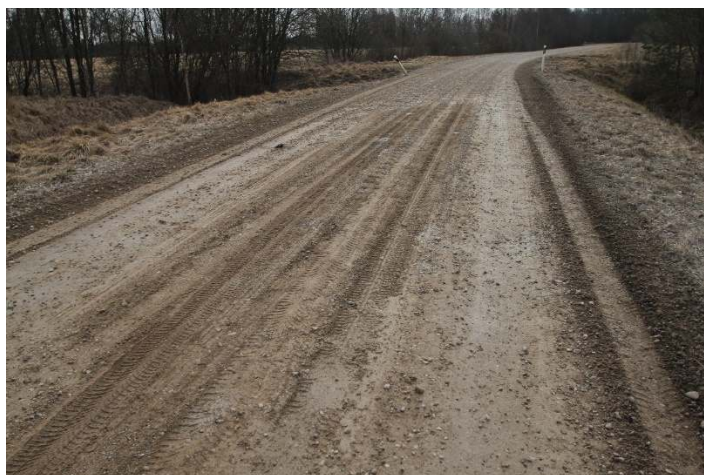
Foto 7. asukohast km 3.82 suunal 2 näitab, et tee keskel on tõenäoliselt külmakerkest põhjustatud kahjustus. Maadaradiprofiil joonisel 4 näitab selles kohas aluskihis kühmu.
