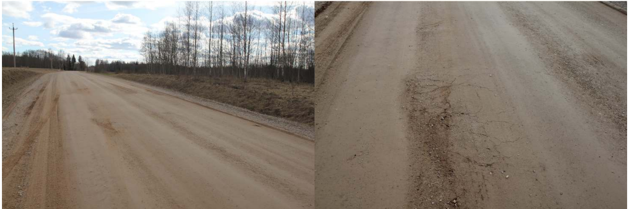
Fotod 3 ja 4 asukohast km 7.50 näitavad probleeme kandevõimega. Nähtava defekti olemusest võib oletada, et keset tõusu pressib vesi välja, mis nõuab dreniiva kihi kasutamist.
