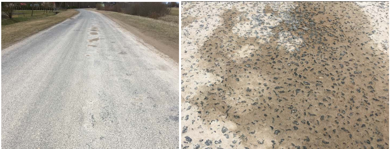
Fotod 1 ja 2 teelõigu algusest (km 7.3), kus peenosis tungib läbi pindamiskihi. Pindamises on sees võrkpraod ning need kohad on ka lohku vajunud.
