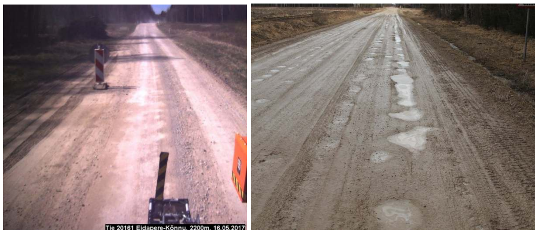
Fotod 4 ja 5. Km 2.180...2.250 vasakul pool teed on teekonstruktsioon liiga suure liivasisaldusega, mistõttu ei kannaks see liiklust. Teekate oli üldiselt väga halvas seisukorras.
