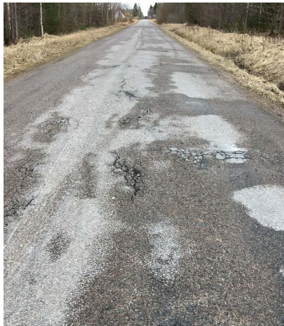
Foto 1. Olukord piirkonnas km 0.75...1.050 – pindamiskiht on purunenud nõrga kandevõime tõttu.
