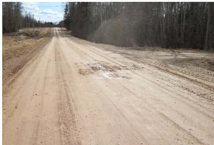
Foto 5 asukohast km 8.00 näitab probleeme kandevõimega ja savise aluspinnase tee keskelt ülespressimisega või üleniiskunud kattekruusaga.
