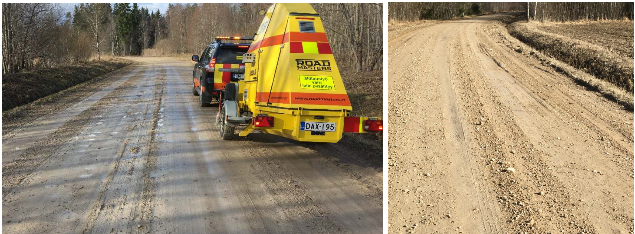
Fotod 7 ja 8. Tavapärane oli olukord, kus teekattes olid roopad, mis lähtusid kattekihi pehmenemisest (näiteks km 9.5), kuid km 7.63 oli koht, kus läbi oli vajunud kogu teekonstruktsioon.
