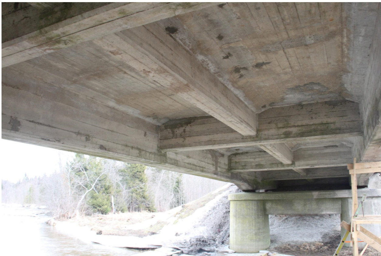
.Foto 9. Silla altvaade. Vee läbijooksujäljed dekiplaadi alapinnas.
