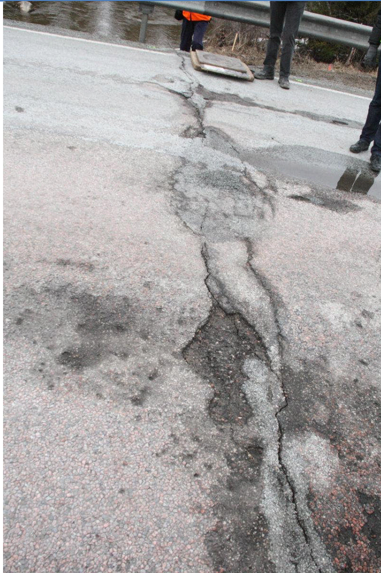
Foto 11. Purunenud ja üles kerkinud asfalt silla talade konsoolide lõpus peale maksimumkoormuse 200t rakendamist
