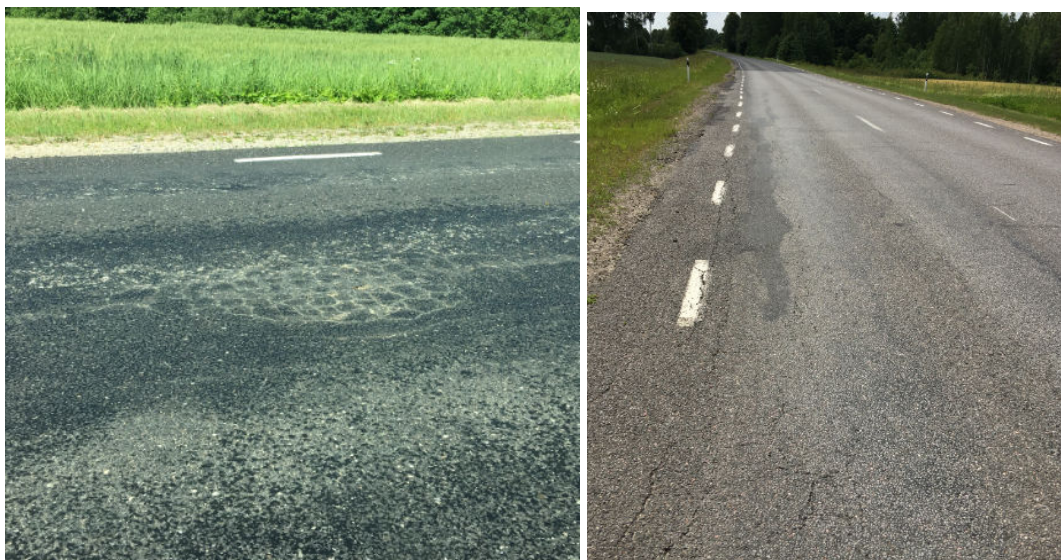
Fotod 1.3 ja 1.4. Võrkpragu km 35.8, roobas ja praod km 36.6.
