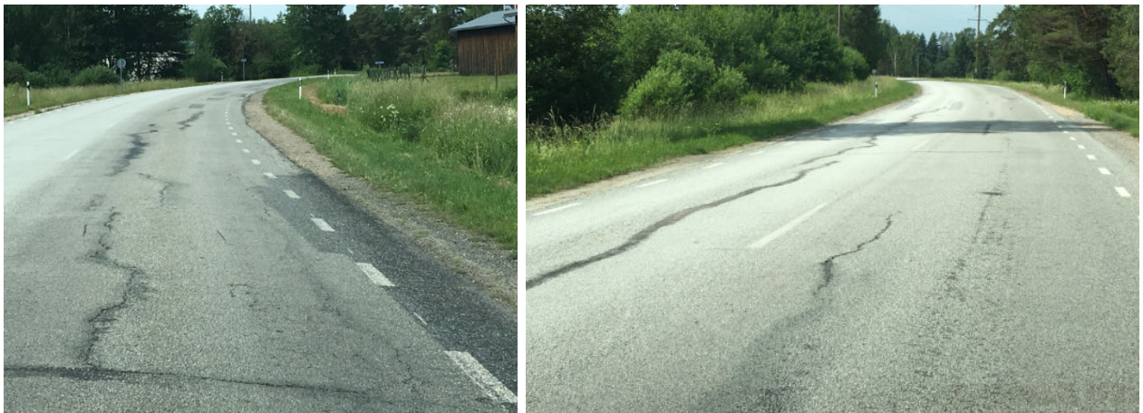
Fotod 1.13 ja 1.14. Mõningad praod vahemikust km 42.0...43.0.
