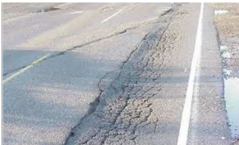
Joonis 8. Hilisemad võimalikud probleemid võivad olla suured hoolde ja remondikulud 2+1 teelõikudel kui varakult 2+2 laiendamiste võimalusega ei arvesta nõrkadel pinnastel (rattajälge sattudes võib laiendus kiiresti ära vajuda lisaks tavapärasele vajumile).
