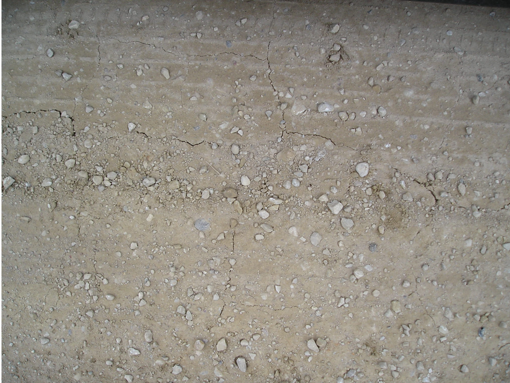
Joonis 1.1. Soolõigu teepind enne remonti
