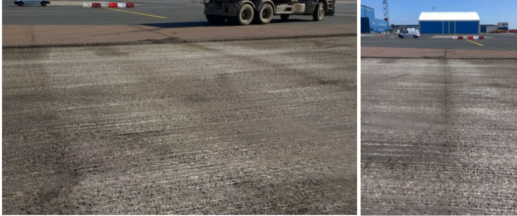
Joonise 5.33. Platsil esinevad defektid olid pikipraod.
