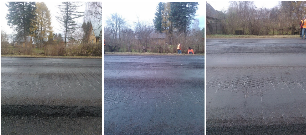
Joonised 1.34...1.36. Defektid terasvõrgus enne asfalteerimist.
