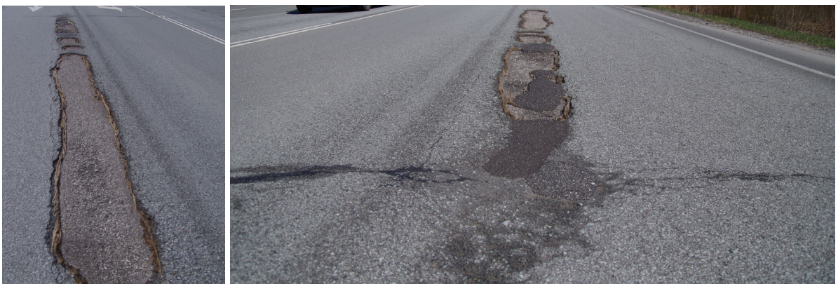
Joonised 4.5 ja 4.6. Tagajärjed, kui asfaldivõrgu paigaldus ei ole olnud korrektne. [Fotod Ragnar Fortuna-Juks]
