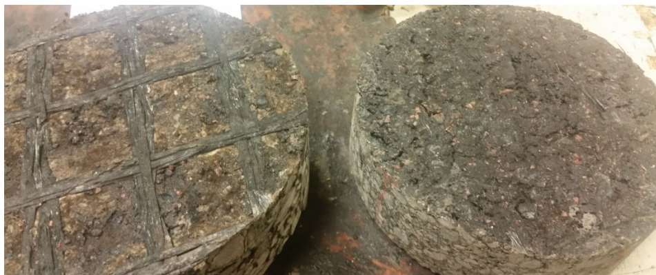
Joonis 5.32. Geotekstiil ei olnud bituumeniga küllastunud (näha on valgeid laiike), mistõttu ei olnud tagatud nake pealmise asfaltbetooniaga.
