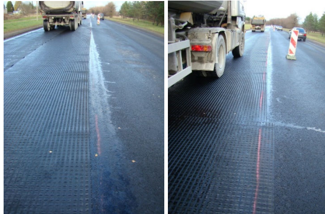
Joonised 1.53 ja 1.54. Kõveralt paigaldatud geosünteed ei võimaldanud kõrvalpaani ülekattet pärast asfalteerimist.
