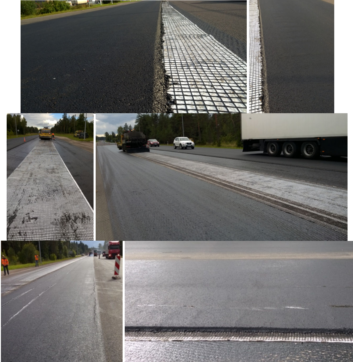
Joonis 5.29. Suureks probleemiks oli asfaldivõrgule paigaldavata asfaldi mittehaakumine tootega. Probleemiks oli liiga vähene bituumen ja õhuke kihipaksus.
