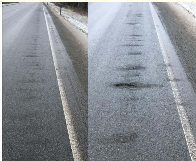
Joonis 5.31. Kogu objekti pikkuses on näha, et asfaltkate ei haakunud tugevalt asfaldivõrgu külge põhjustades poorseid ja pragunenud kohti.
