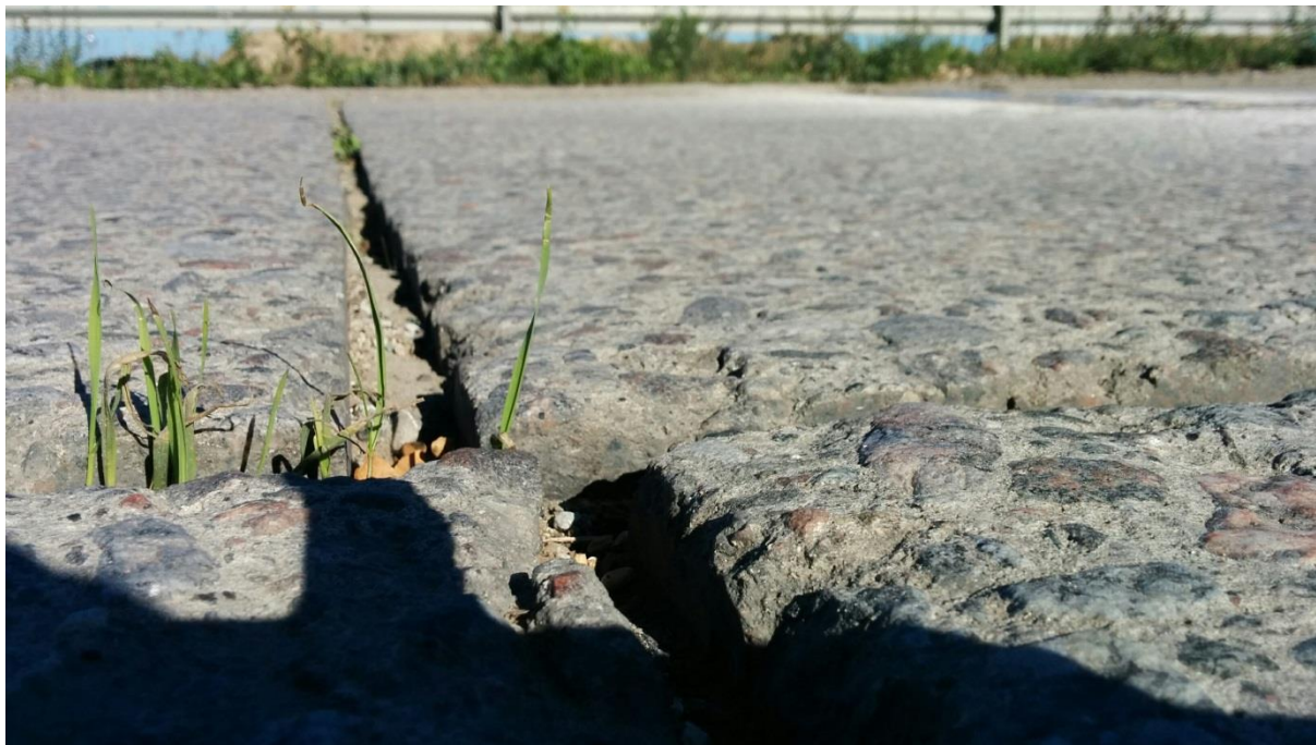
Foto 3. Betoonplaatide omavaheline nihe
