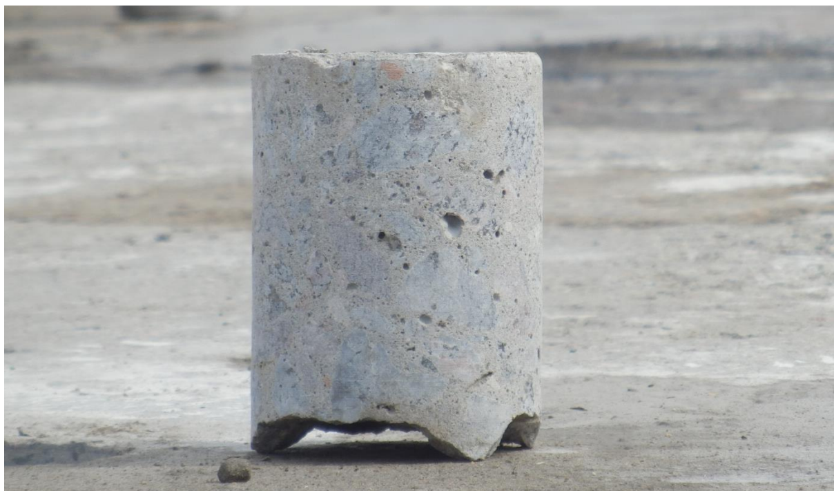
Foto 5. Betoonkattest võetud puurkeha
