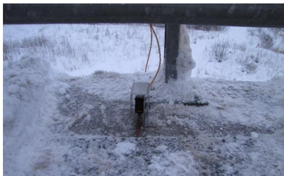
Foto 51. Seadmed Aseri viaduktil
