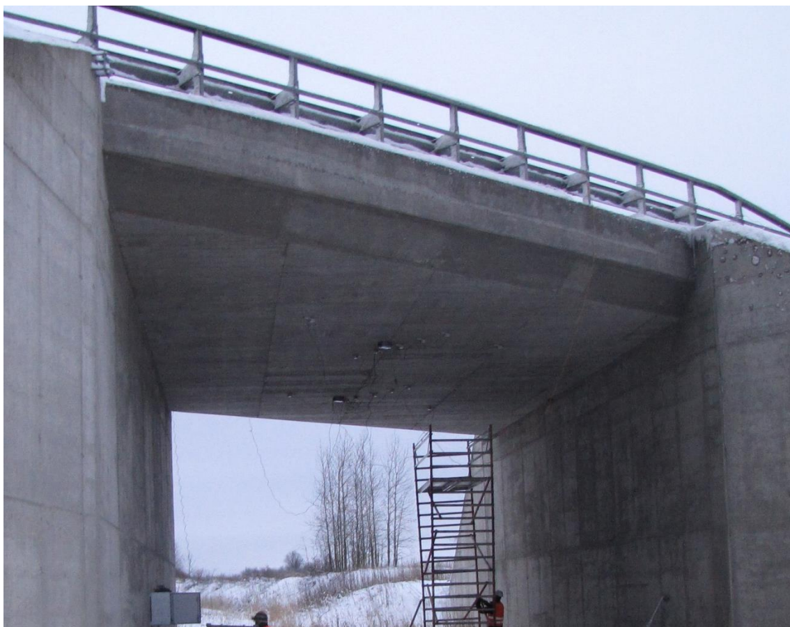
Foto 49. Seadmed Aseri viaduktil
