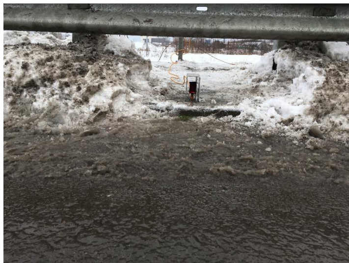
Foto 56. Seadmed Maardu järve jalakäijate tunnelis
