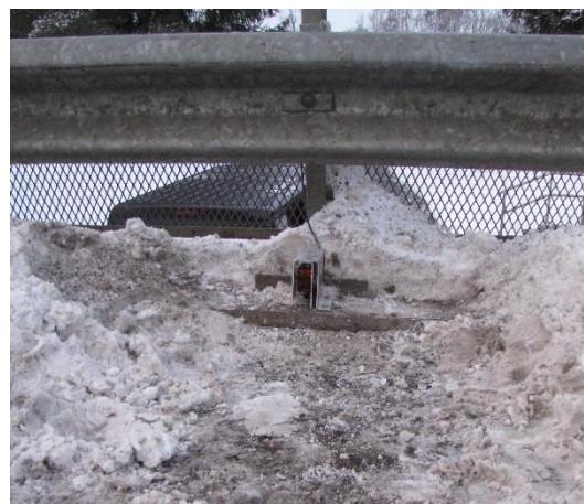
Foto 48. Seadmed Kõrveküla kergliiklustee tunnelis
