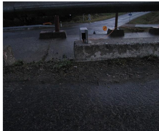
Foto 43. Seadmed Pinska viaduktil
