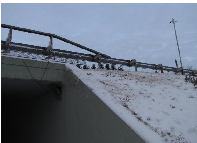
Foto 47. Seadmed Kõrveküla kergliiklustee tunnelis
