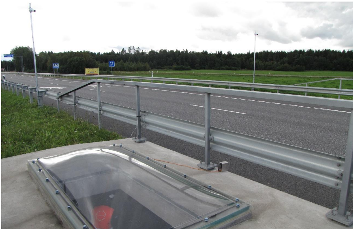
Foto 37. Seadmed Piuga jalakäijate tunnelis (Tartu suund)
