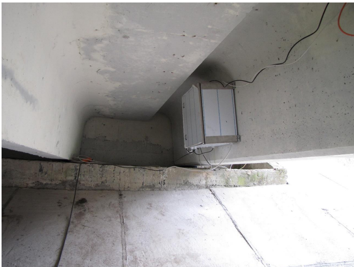
Foto 18. Seadmete ühenduskapp Parila sillal
