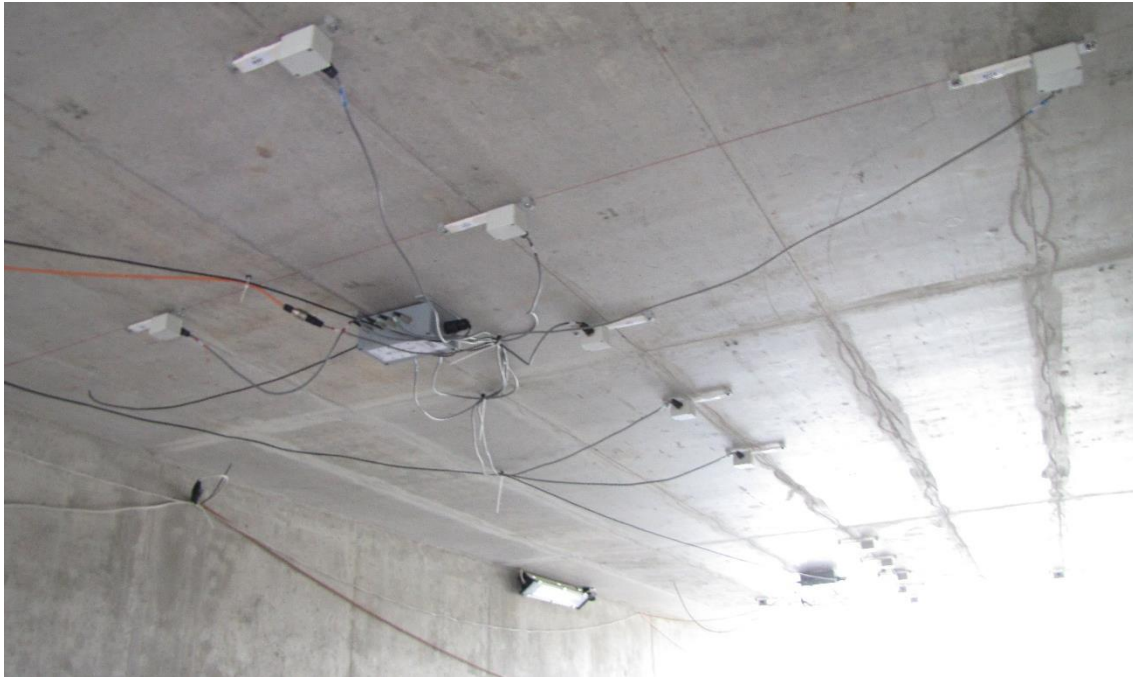
Foto 36. Seadmed Piuga jalakäijate tunnelis (Tartu suund)
