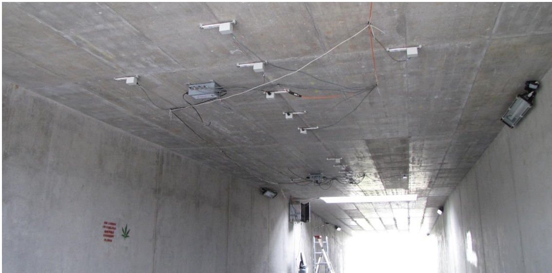
Foto 34. Seadmed Piuga jalakäijate tunnelis (Tallinna suund)
