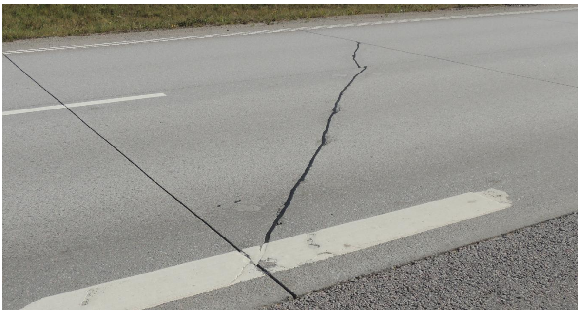
Foto 14. E4 Uppsala, betoonplaadi murdumine, september 2013
