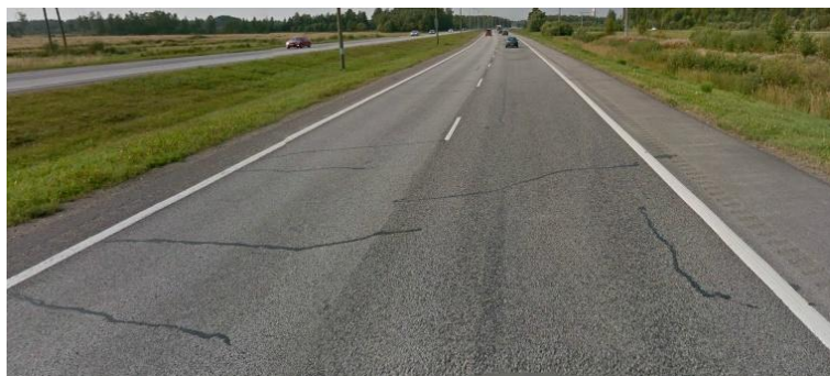
Foto 1. Vt 4 Kempele-Kiviniemi. Betoonplaatide purunemine, aprill 2009
