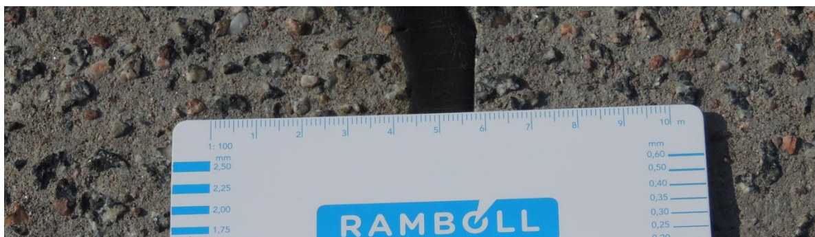
Foto 15. E4 Uppsala, betoonplaadi murtud koht täidetud mastiksiga, september 2013
