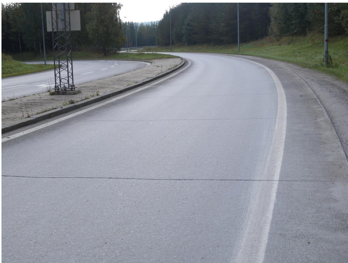
Foto 5. Vt 9 Lakalaiva, betoonkate on säilinud vaid mõnel rambil, september 2013
