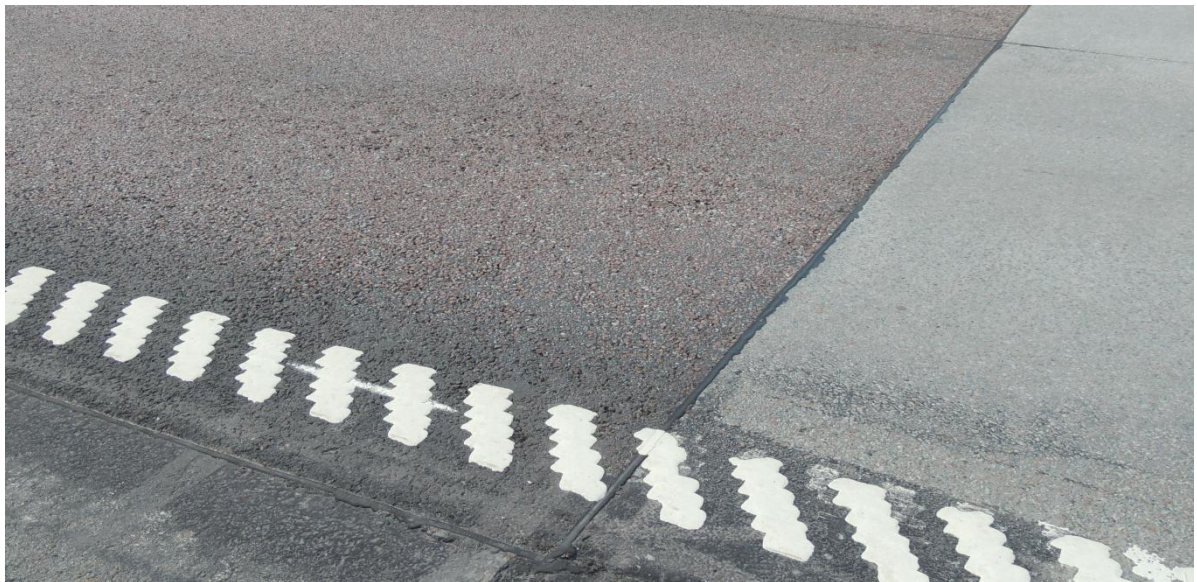
Foto 11. E4 Uppsala, remondilõigu üleminek, kattemärgistus, september 2013
