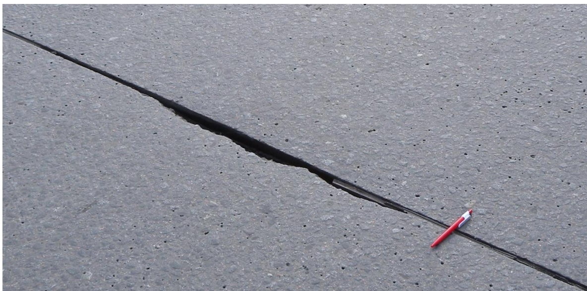
Foto 6. Vt 9 Lakalaiva, betoon on murenenud vuugi juures, september 2013
