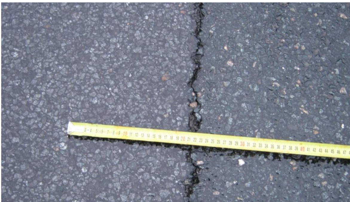
Foto 70. Põikvuuk vajab remonti (2010)
