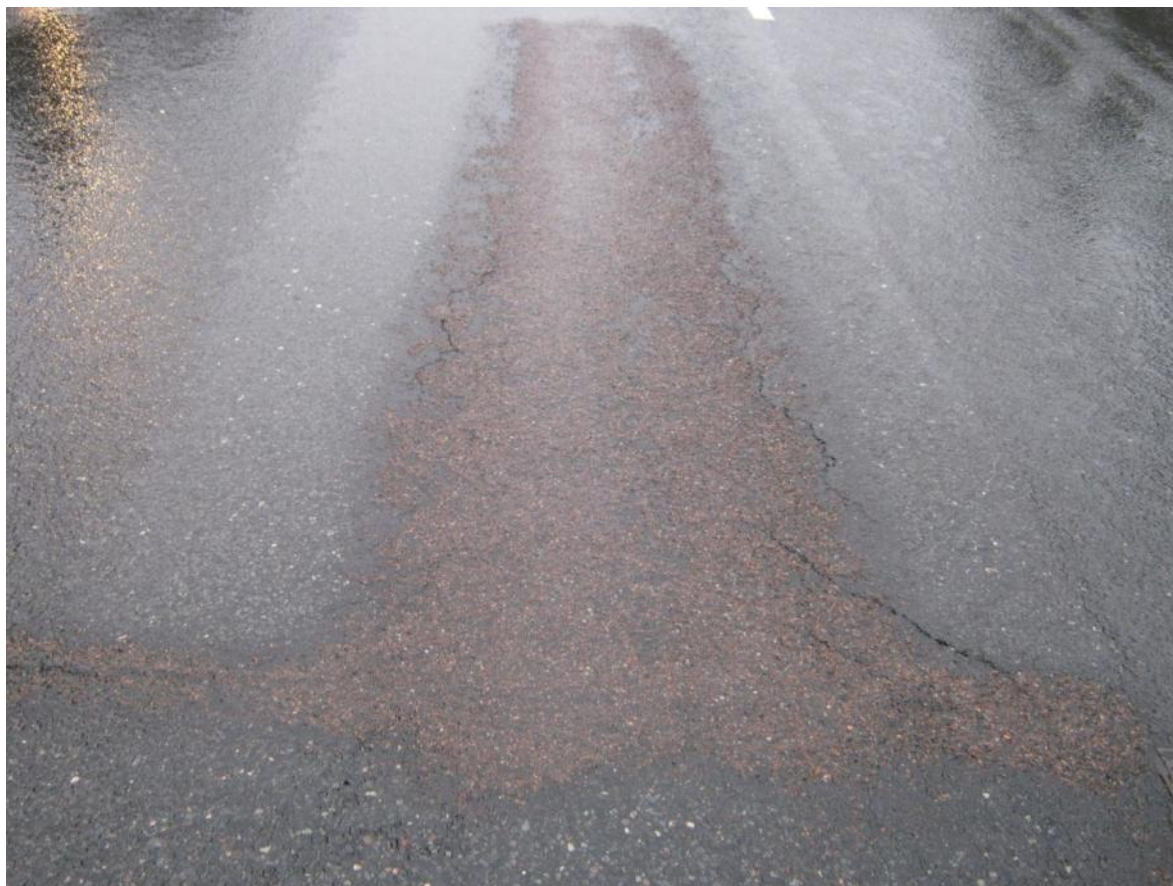
Foto 58. Kandevõime kadu ei ole võimalik kõrvaldada pindmise remondiga (2010)
