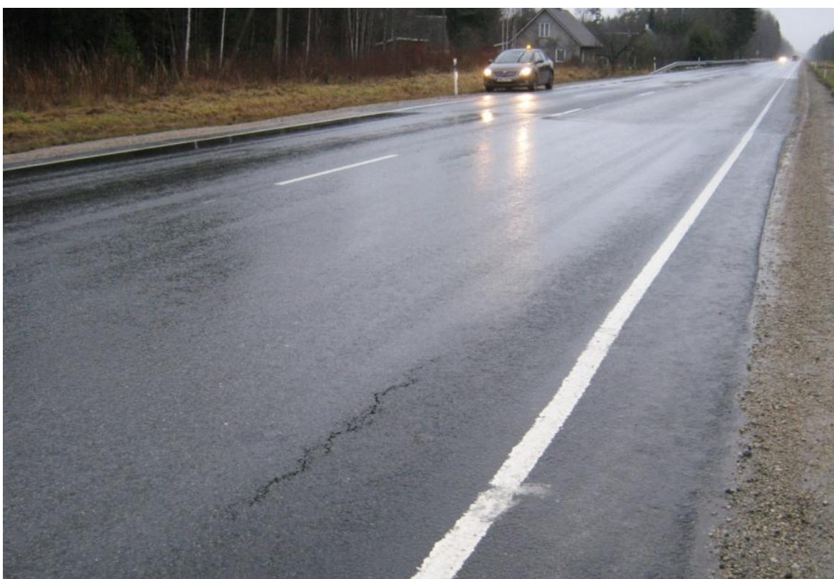
Foto 72. Aluse deformatsioon vasakul suunal (2010)
