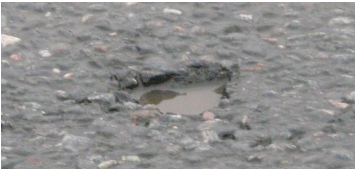
Foto 17. Katendi defekt bussipeatuse juures (2010; km 23,1)
