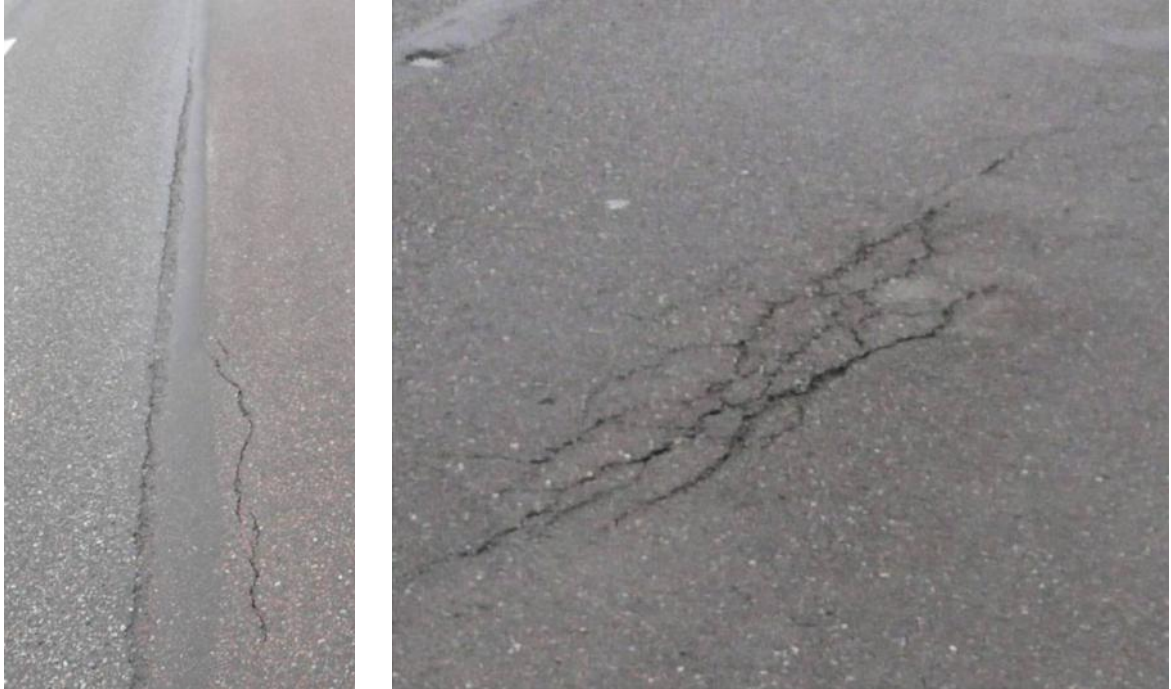
Foto 21. Defektid Kanama liiklussõlme rambil, 2009
