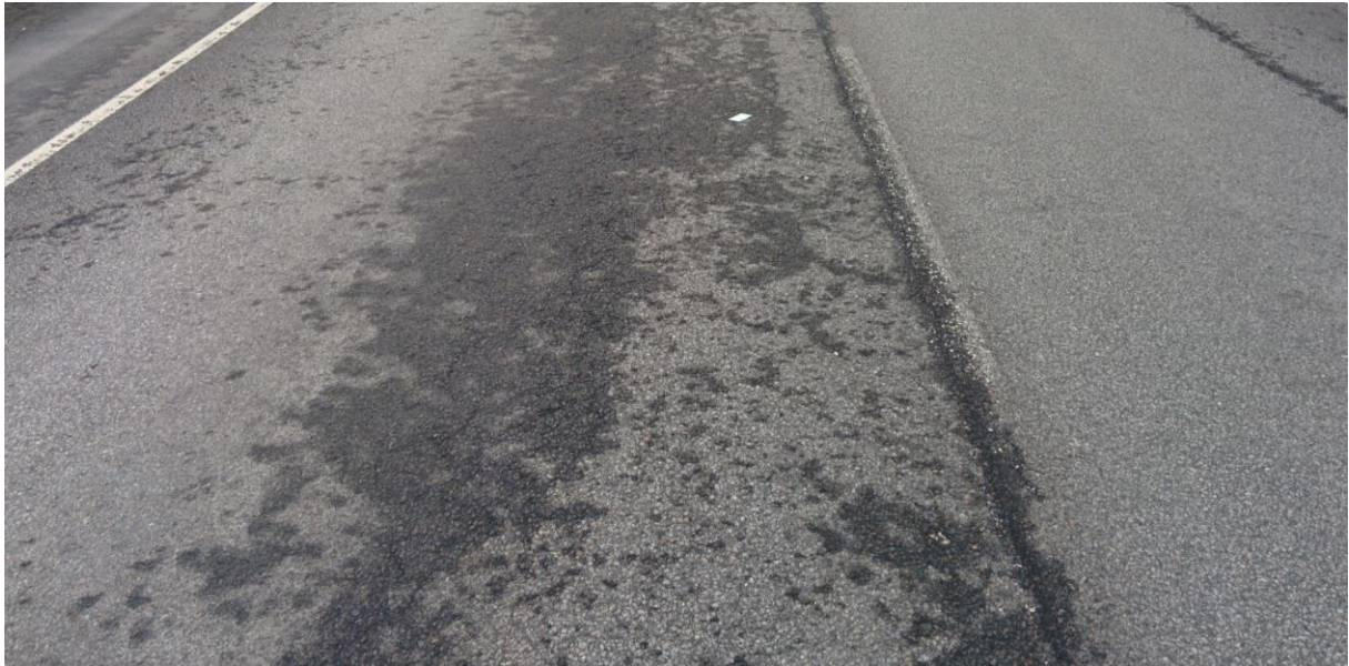
Joonis 21. Lagunemise tundemärkidega poorsed kohad kattes
