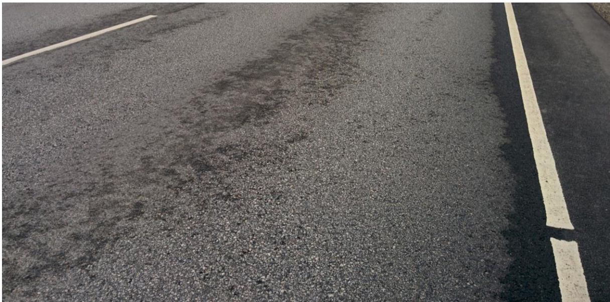
Joonis 22. Lagunemise tundemärkidega poorsed kohad kattes
