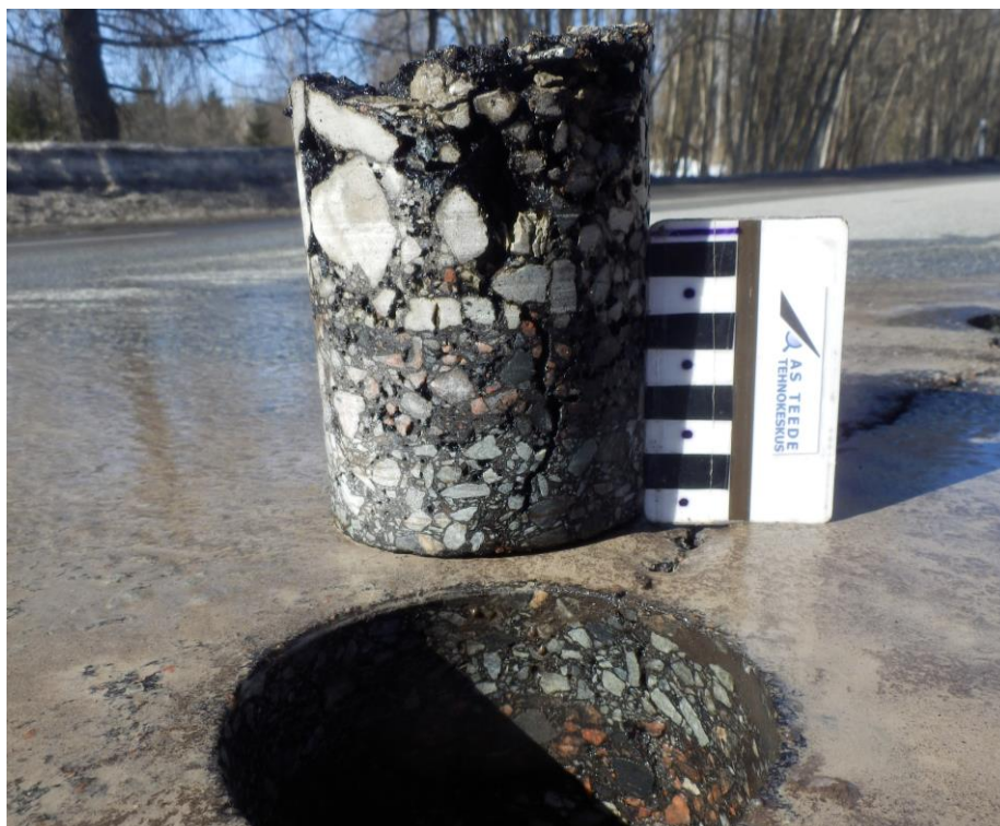
Joonis 30. Pragu 3 terasvõrguga lõigul, kevad 2013, 2...3 mm
