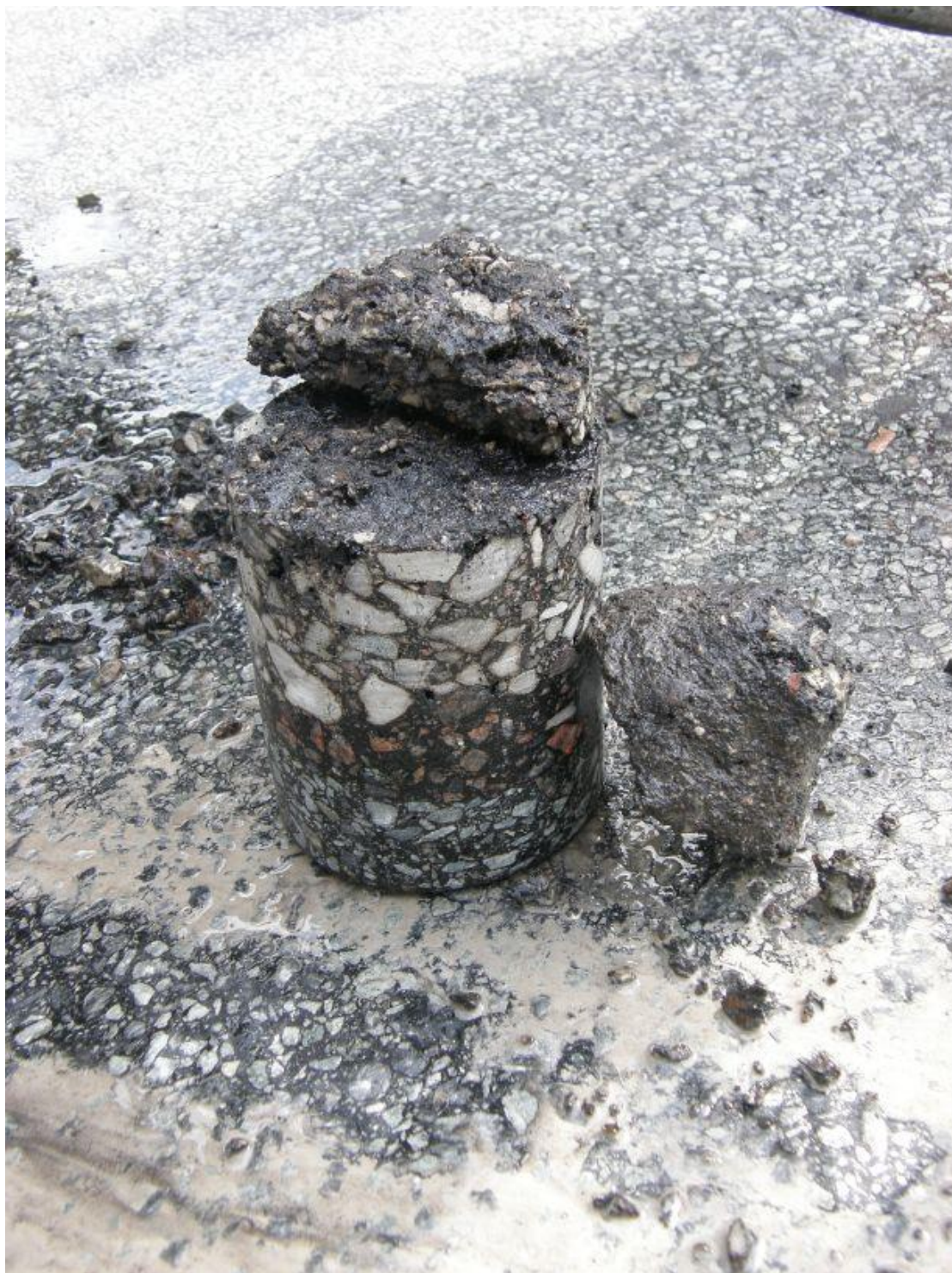
Foto 3. Puuraugus B1 on näha Hatelit C asfaldivõrk ja purunenud vana kate selle all 2011
