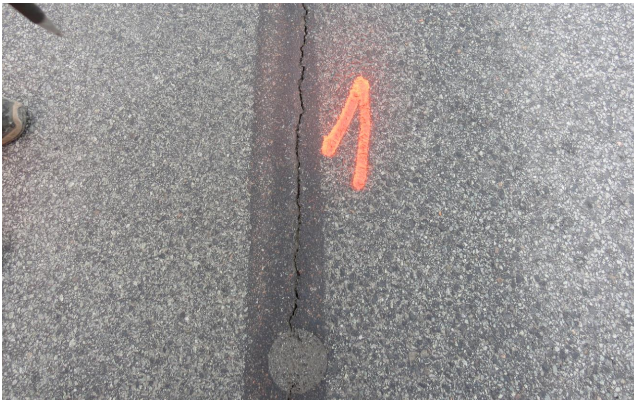
Foto 2. Aastal 2013 avanenud pragu terasvõrguga löigul (foto Raxoest)
