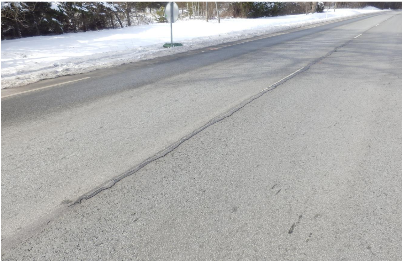
Foto 1. Vaade objektile puuringute ajal, kevad 2014, pärast pragude täitmist mastiksiga
