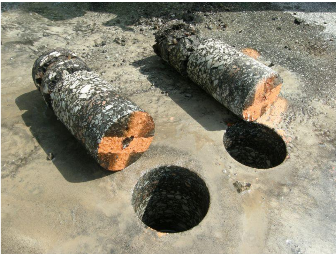
Foto 2. Puuraugus A1 on näha terasvõrk kuid kummaski puuraugust ei tuvastatud pragu vanas kattes 2011
