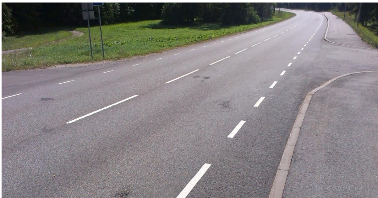
Joonis 1. Asfaltkatte lagunemise näide Roelas
