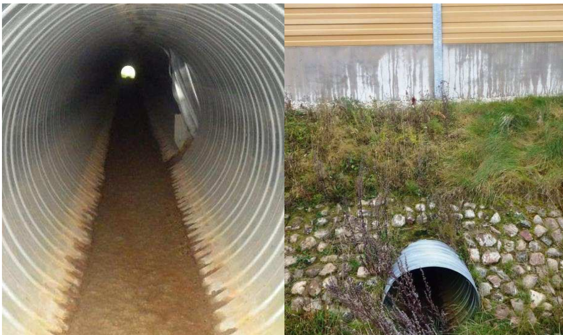
Foto 4. ja Foto 5. Müratõkke seina vundamendi posti poolt kahjustatud truup
