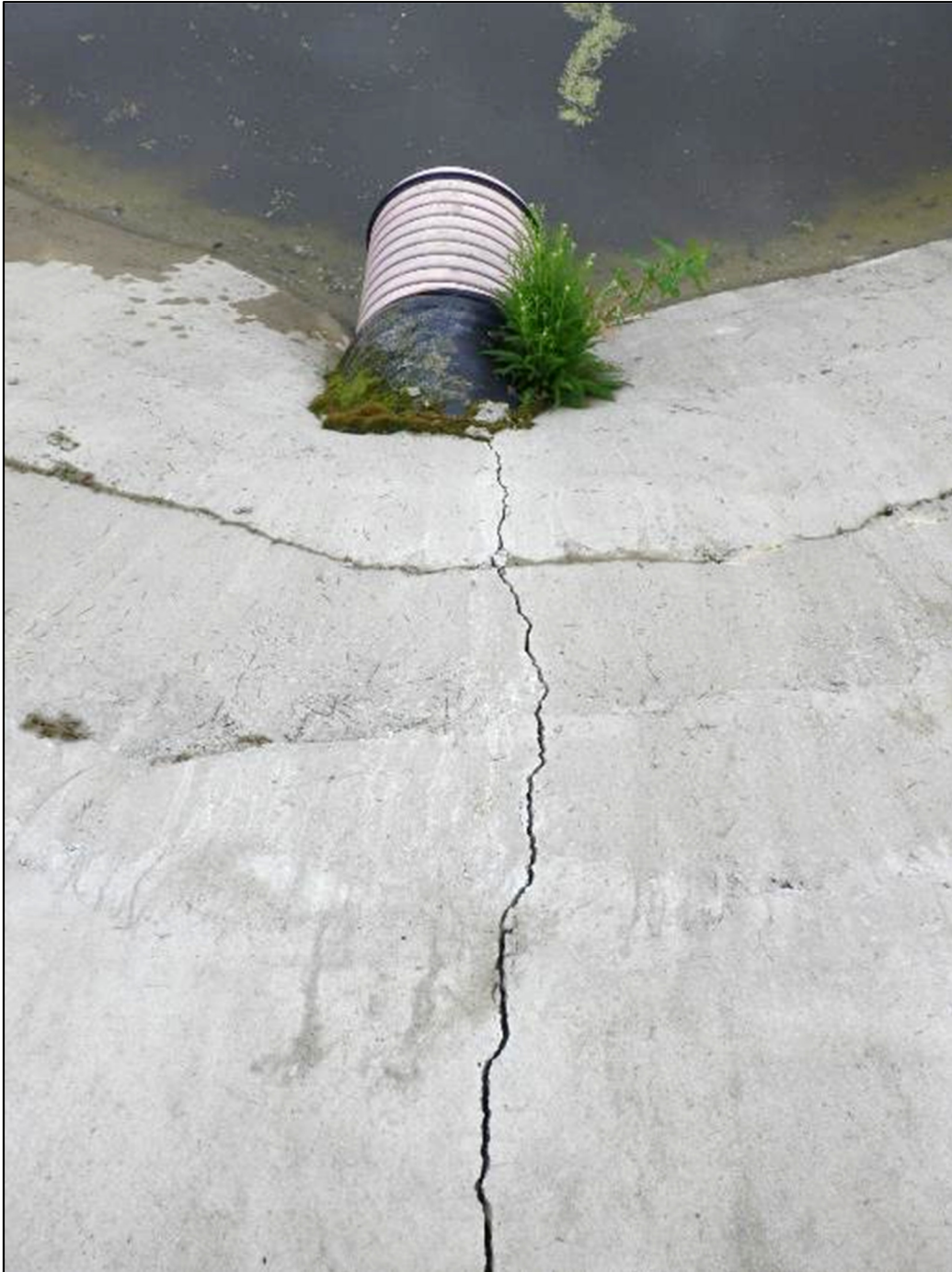
Foto 9. Kurna IV süsteem, mõra betoonkonstruktsioonis settebasseini sissevoolu lähedal (14.06.2019)
