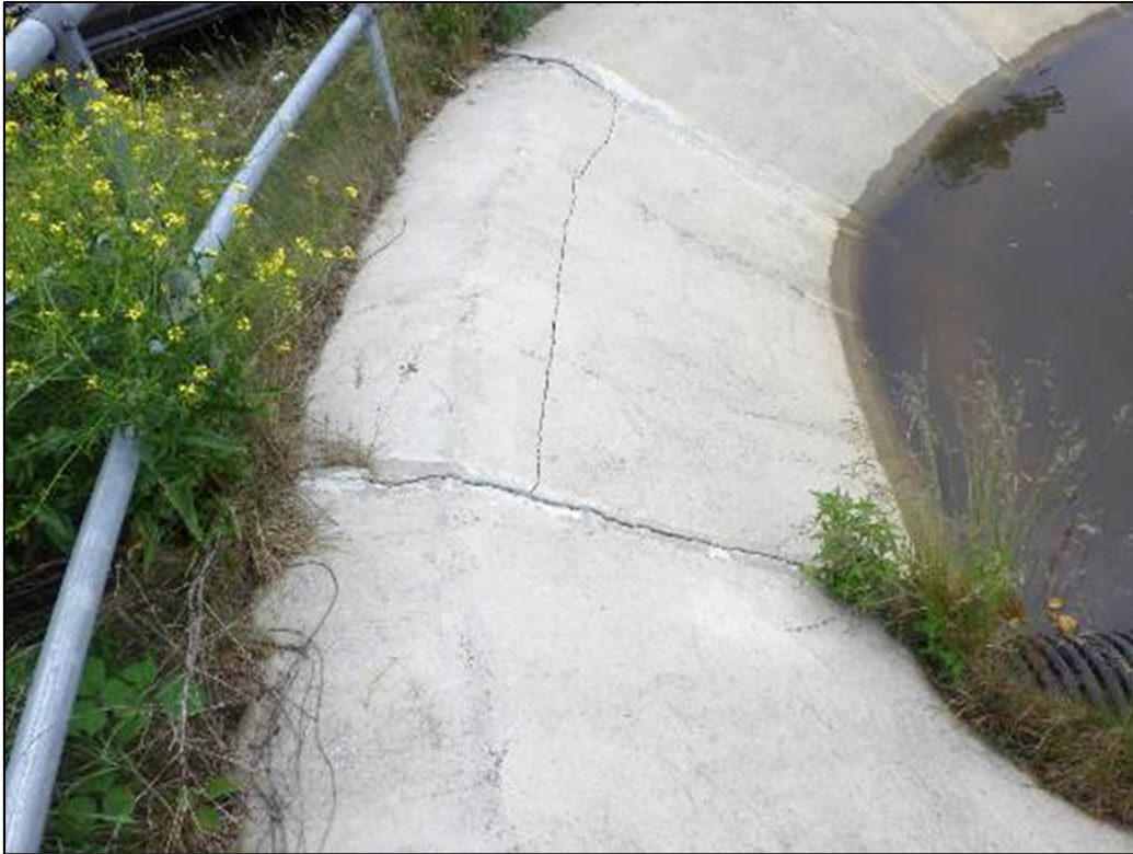
Foto 16. Kurna-Luige II süsteem, mõrad betoonkonstruktsioonis settebasseini sissevoolu lähedal (14.06.2019)
