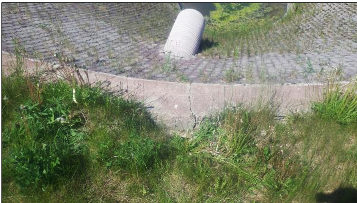
Foto 14. Kukruse-Jõhvi VI süsteem, pinnaseerosioon ning mõra betoonkonstruktsioonis settebasseini sissevoolu lähedal (05.06.2019)
