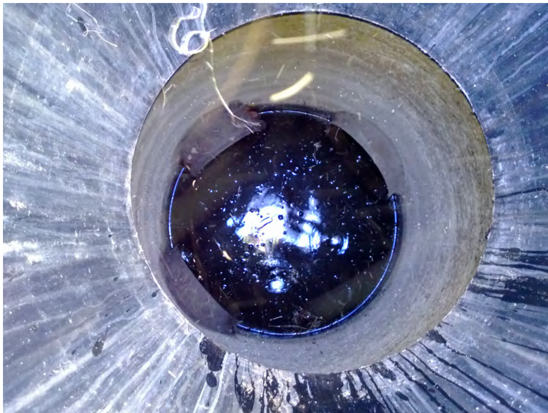
14 Sademevee kollektorkaev 14 vesi ja pinnas olid reostustunnustega
