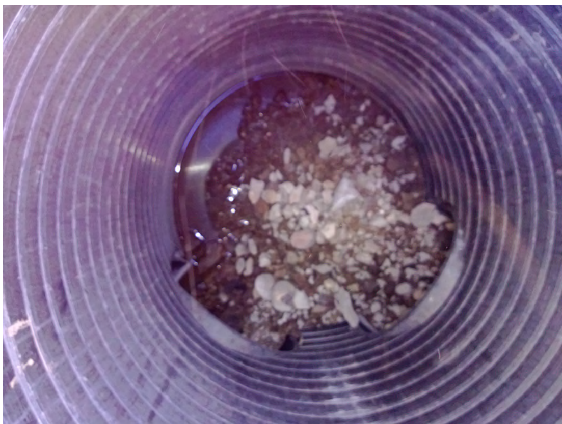
22 Liiva-õlipüüdurisse sisenev kollektorkaev oli kuiv
