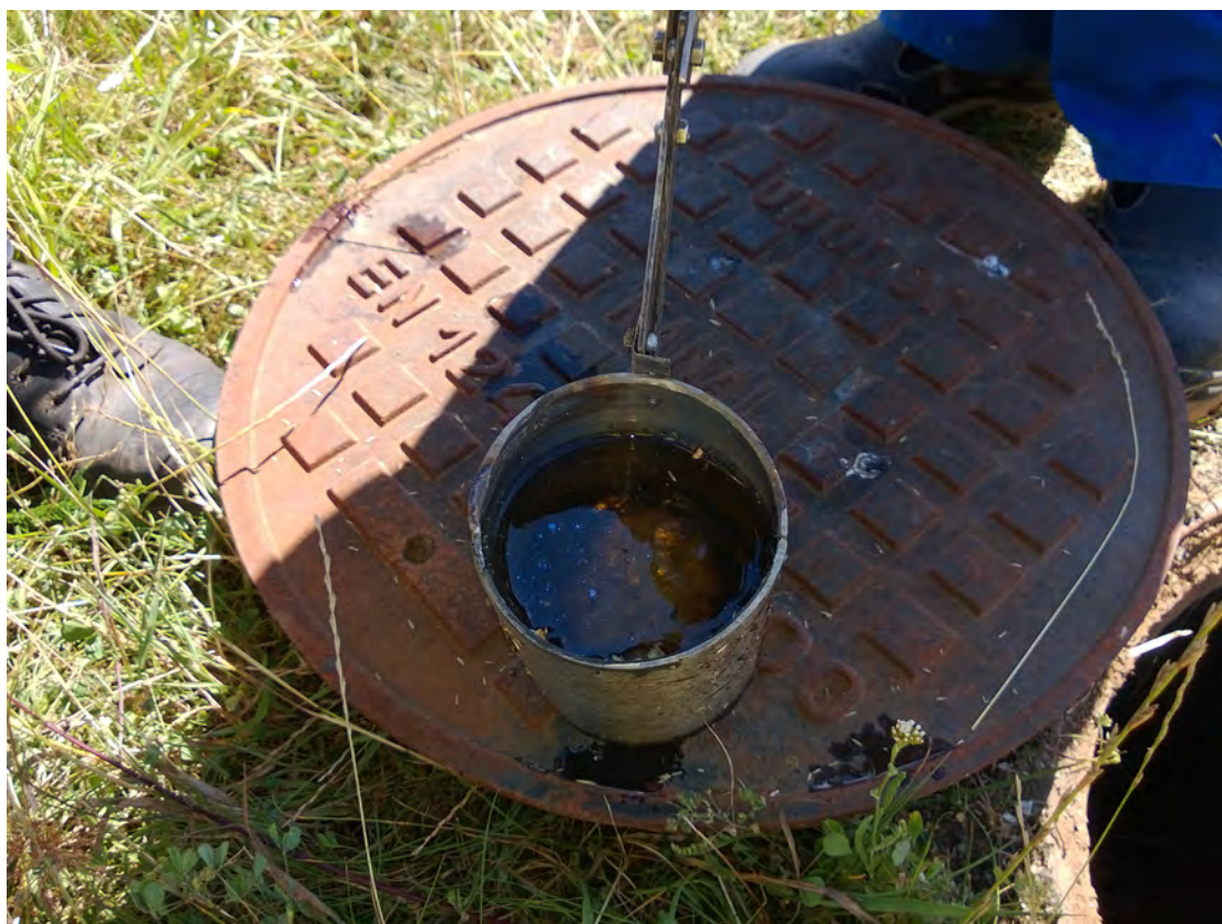
9 Sademevee kollektorkaevu 7 vesi oli naftasaadustega reostunud
