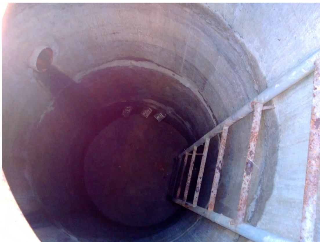
1 Alexela automaattankla settekaev kolme imutustoruga
