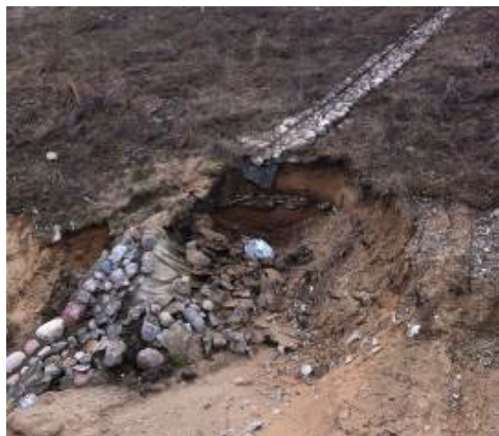
Foto 36. Maardu, varisenud sademevee äravoolunõva maanteelt vaadatuna
