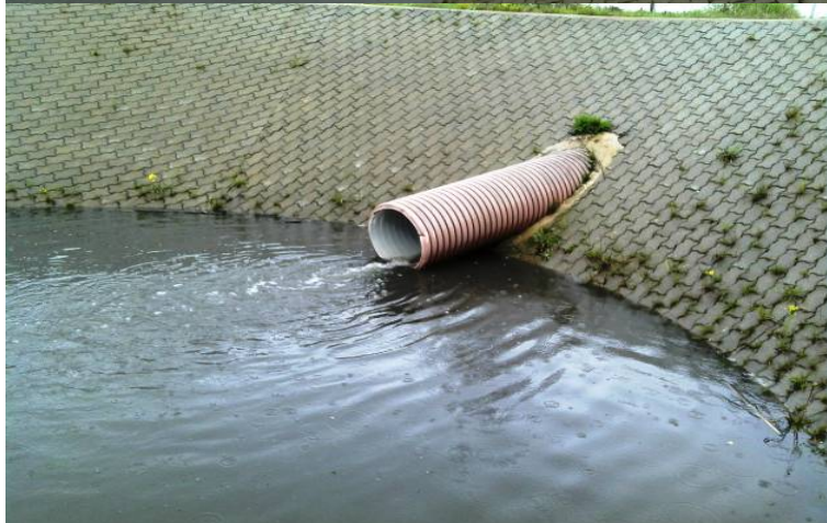
Foto F4 Vee väljavool sademevee-süsteemist Jõhvi I õli-liivapüüdurisse (13.05.2014)
