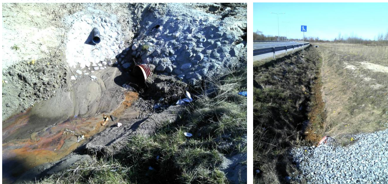
Foto 13 Vasakul põhjasuunas väljaulatuva truubi ots ja tee pealt kogutava sademeveedrenaaži toruots (väiksem). Tuubist väljuv rauarikas vesi suundub kraavis põhja suunas ja suubub kauguses nähtavasse järgmisse truupi
