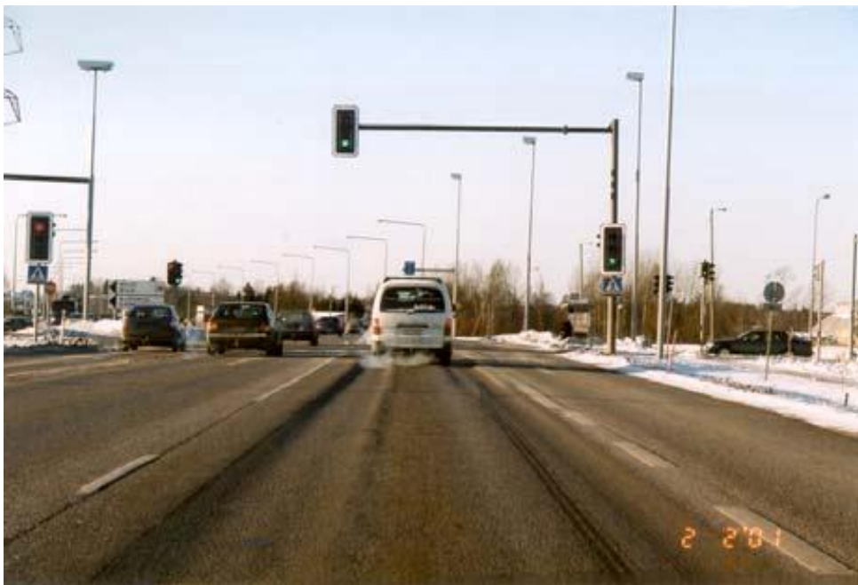
Pilt 1. Deformatsiooniroopad asfaltkattes.
