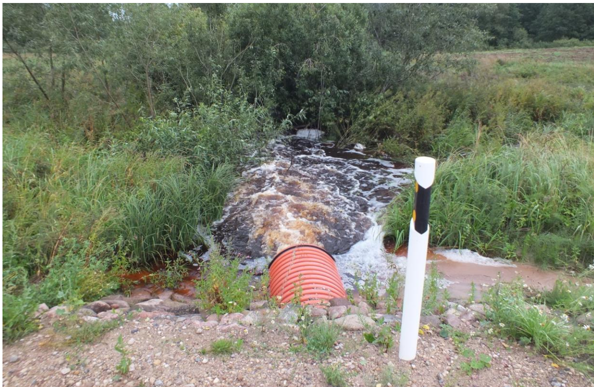
Foto 8. Truup 18207 Niitsiku - Kahkva teel, truup on paigaldatud liiga kõrgele, Viinakuakraav on võssa kasvanud ja takistab vee äravoolu
