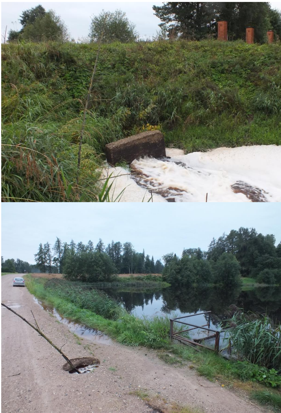
Foto 5. 18207 Niitsiku - Kahkva tee Kahkva külas. Plotina paisu tõttu ulatub vesi teele. Pinnaste veelaskmesse uhtumise tulemusel on tees auk (pinnase ärakanne kestab). Alavee poolel (ülemine foto) on veelaskme otsak amortiseerunud
