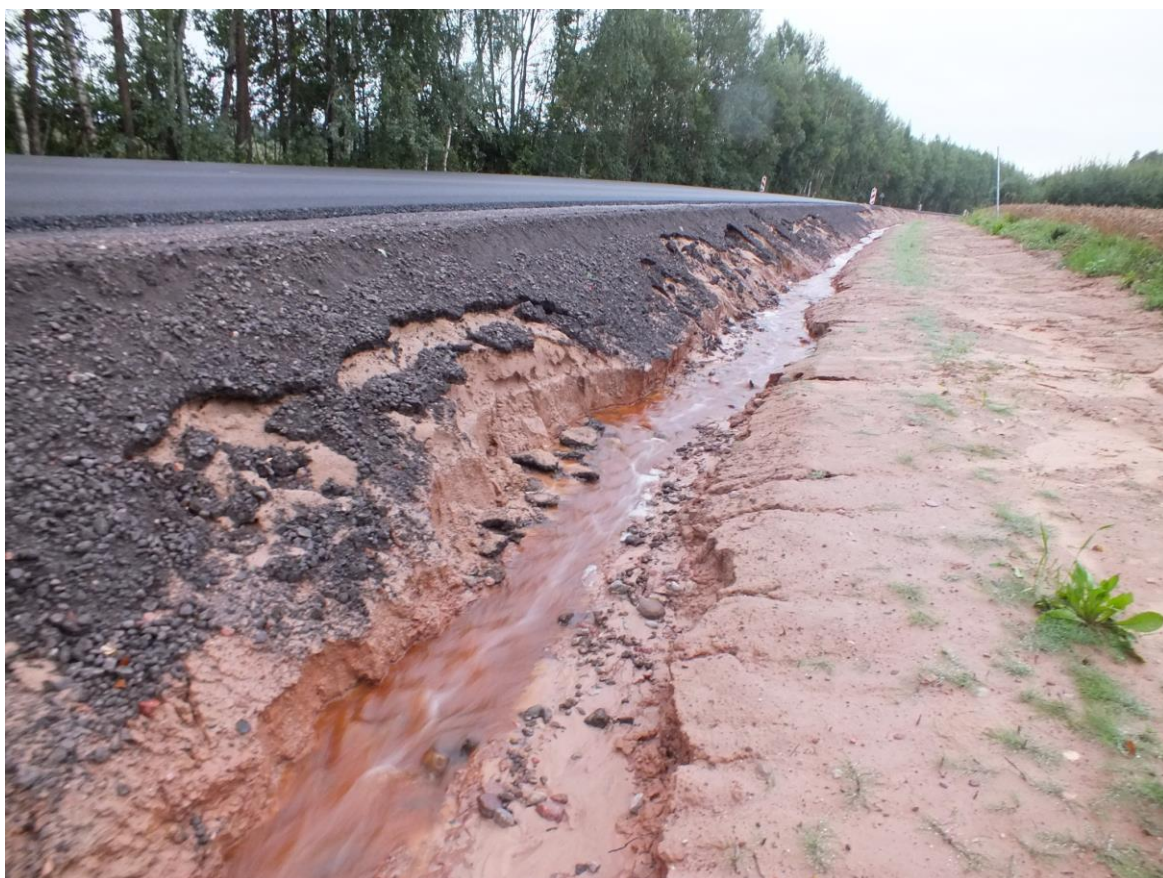
Foto 15. 90 Põlva - Karisilla tee mulde ja kraavi erosioon, tee mulde nõlv liiga järsk, nõlv varisenud, pinnas minema uhutud. Ehituse käigus rajatavad voolusängid tuleks kindlustada võimalikult varakult
