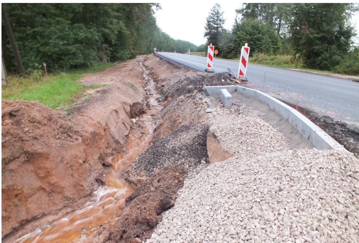
Foto 17. 90 Põlva - Karisilla tee mulde ja kraavi erosioon, nõlv varisenud, pinnas minema uhutud. Oluline on rajada kraavi kindlustis võimalikult varakult.
