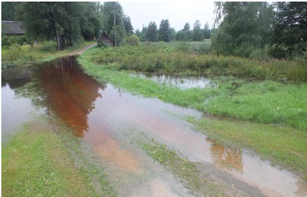
Foto 10. Foto 10. Veersu oja üleujutus Palujärve ja Kübara kinnistu juurdepääsuteel. Vahetult allavoolu 18206 Rahumäe-Kahkva tee all Veersu ojal olev binokkeltruup (vt foto 11).
