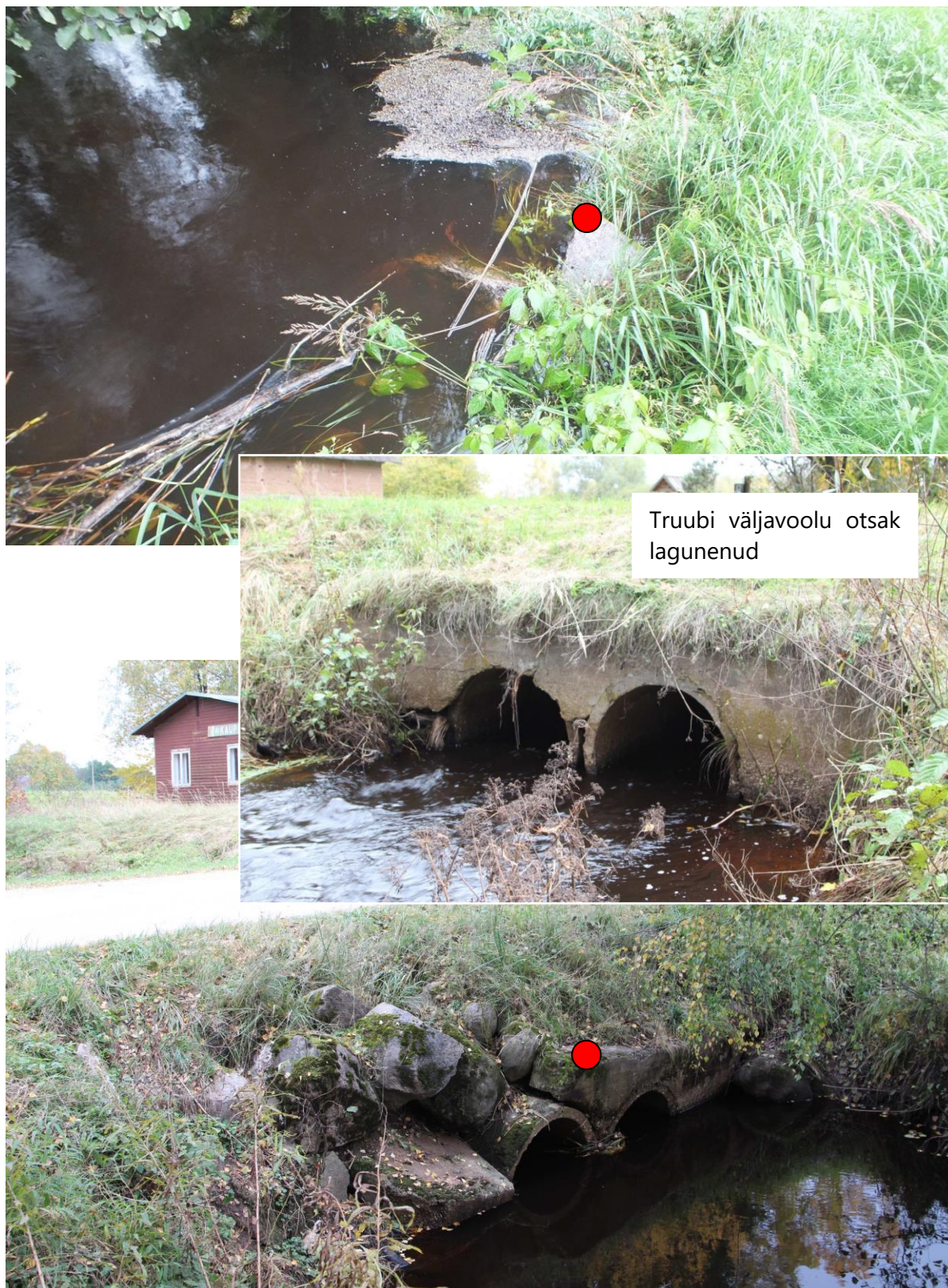
Foto 11. Rahumäe-Kahkva tee all Veerksu ojal olev binokkeltruubi sissevool uputatud (ülemine foto, 24.08.2017) ja uputamata olekus (alumine foto, 10.10.2017). Otsak lagunenu, ilmselt vajab kogu truup uuendamist. Võimaluse korral tuleks asendada üheavalise suurema truubiga
