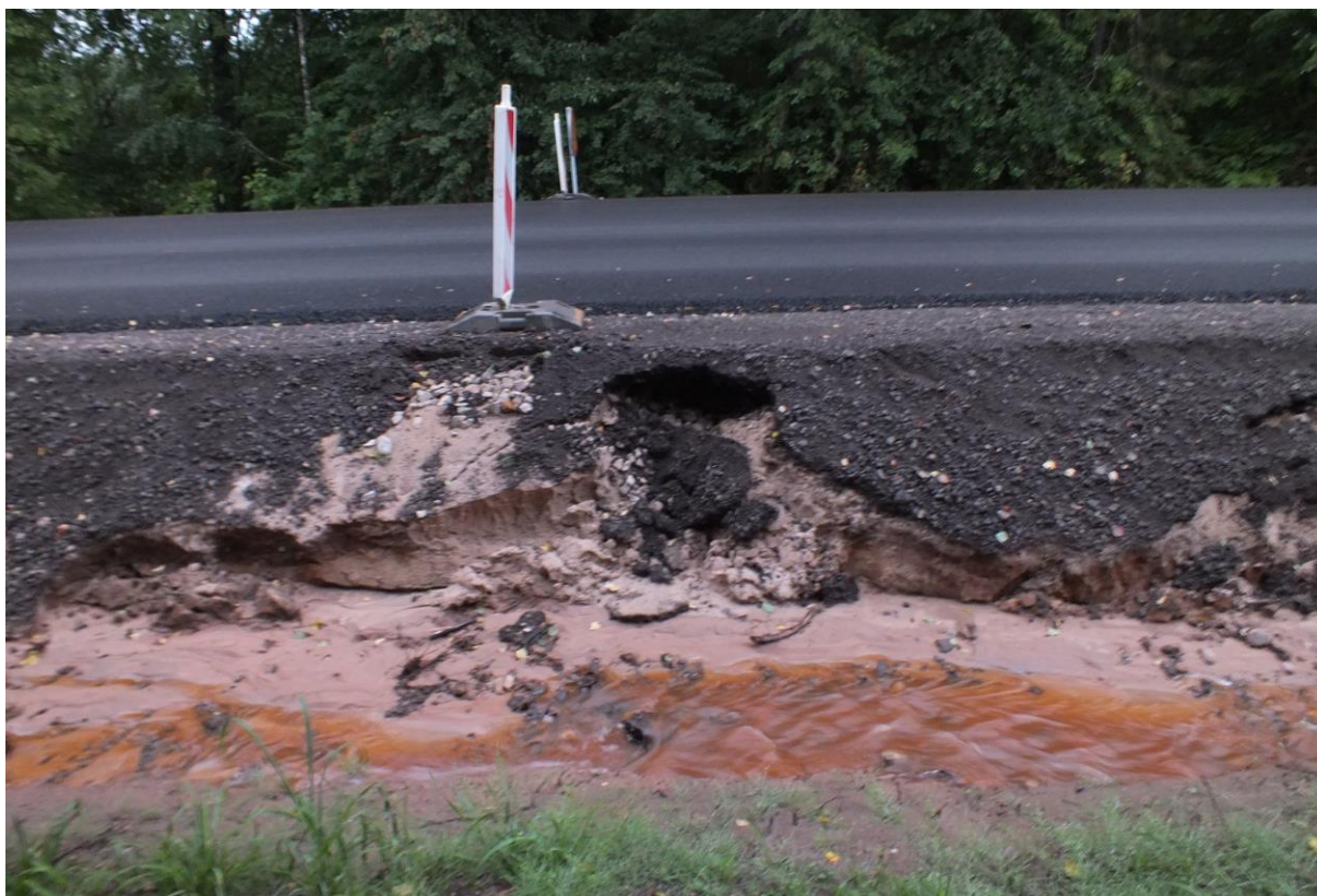
Foto 16. 90 Põlva - Karisilla tee mulde ja kraavi erosioon, nõlv varisenud, pinnas minema uhutud. Protsessi jätkumine viib teekatte lagunemiseni
