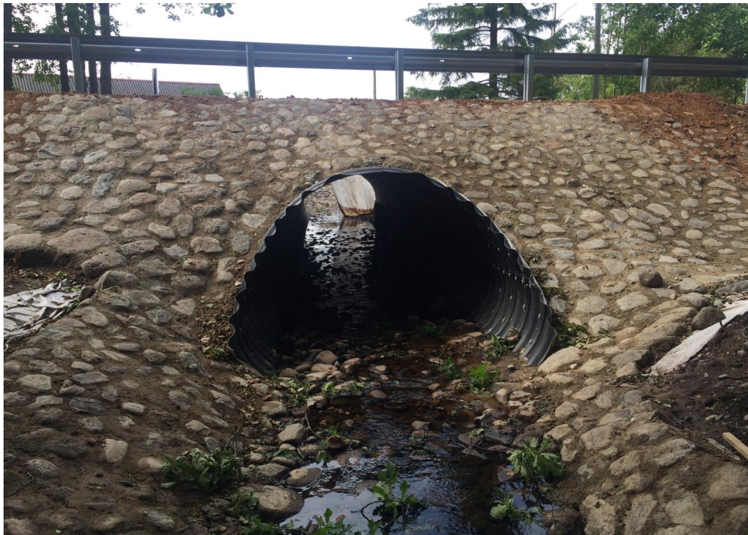
Foto 19. Majaka torusild Rannametsa-Ikla tee (19331) all. Kabli maaparandussüsteemi (6034480000040) eesvooluks oleval kraavil. Toru põhi on sobiva languga, paigaldatud kraavi põhjast madalamale ja toru on kraavi põhja kõrguseni tagasi täidetud kividega. Tagatud on nii vee läbijuhtimine kui vee-elustiku rändevõimalus
