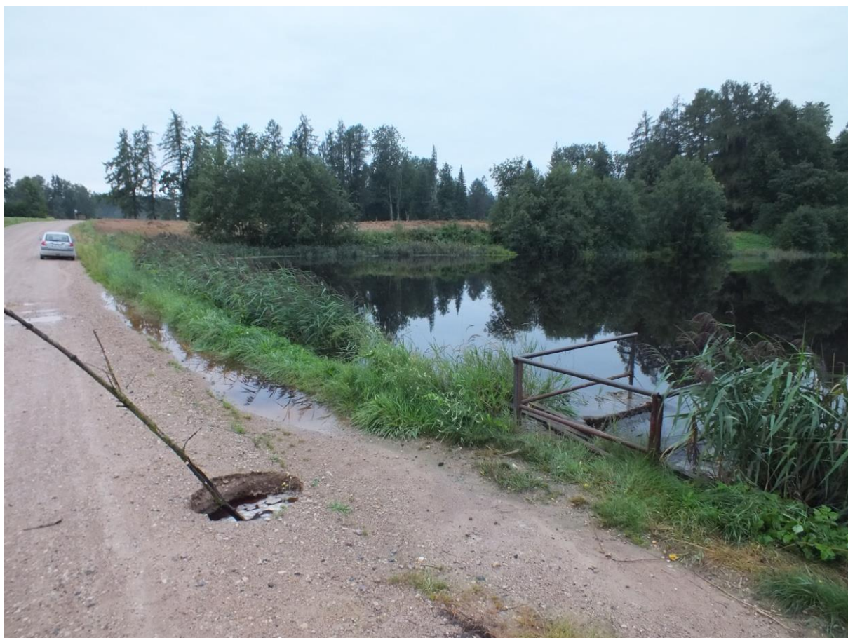
Foto 7. Niitsiku – Kahkva mnt (2,724 - 2,724), Plotina pais, kust varjasid liigveelaskme avast tulvavee läbilaskmiseks eemaldatud ei ole, mistõttu veetase paisjärves on tõusnud tee pinnaga samale kõrgusele. Tee all olevasse torusse toimub muldkeha pinnase sissekanne, selle tulemusel tekkinud auk on tähistatud puuoksaga. Vee ülevooluga kruuskattest kaasneb teekatte erosioon, millele järgneb vee koondumine, mis toob kaasa veelgi suurema erosiooni ja lõpeb muldkeha purunemisega.
