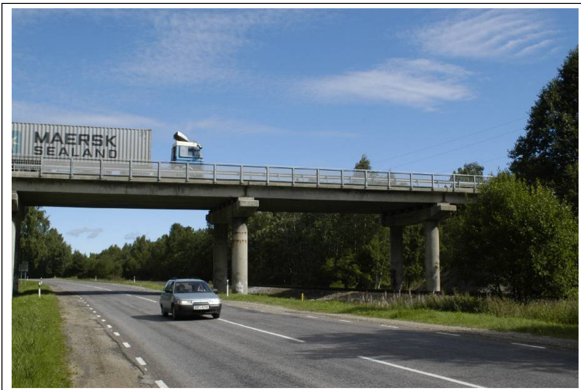
Foto 29. Vaade Saku viaduktile Saku-Männiku teelt viadukti all. Selgelt on näha kuivõrd vähe on siin ruumi loomade võimalikuks läbipääsuks.
