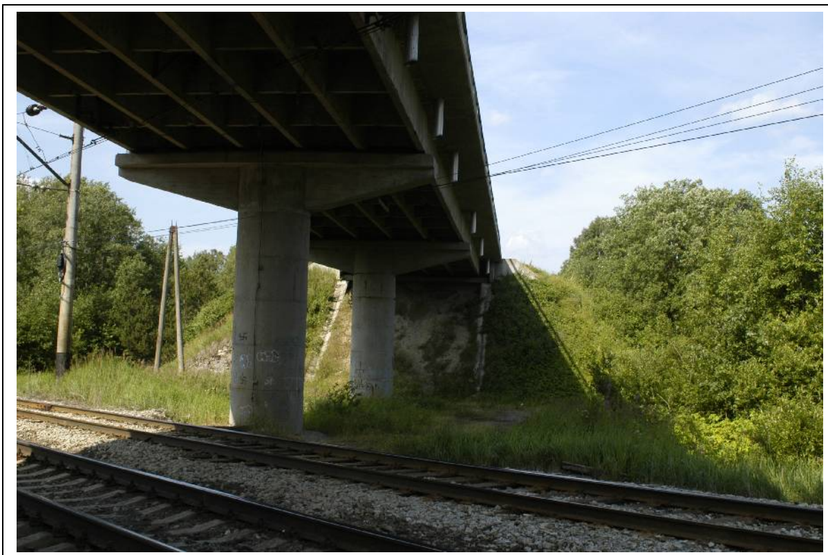
Foto 35. Vaade Valingu viadukti alt Keila suunas, kuhu poole tuleb ka pikendada viadukti tammi, kaotades kurvi kohe peale viadukti. Pikendatud viaduktiossa tuleb rajada metskitsedele mõeldud läbipääs.
