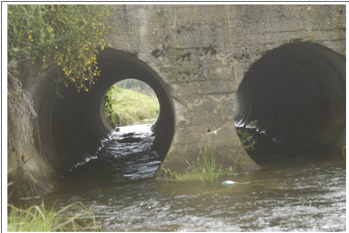
Foto 8. Vanamõisa peakraavi kaksiktruup 21. kilomeetri keskel. Läbipääsu suhteliselt suured mõõtmed ja valgusküllus võimaldavad siin ilmselt rebaste ja kährikute läbipääsu.
