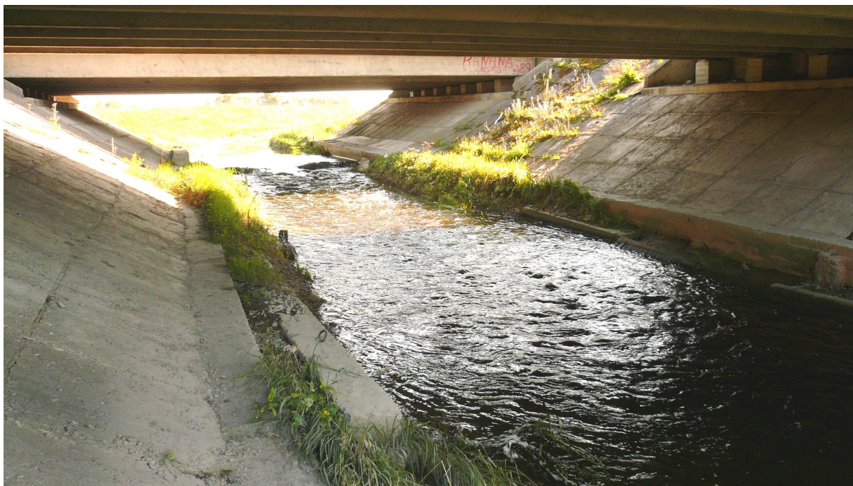
Foto 6. Maidla jõe sillaalune (25. km), looduslik kallasrada puudub, betoonist kalded on liiga järsud
