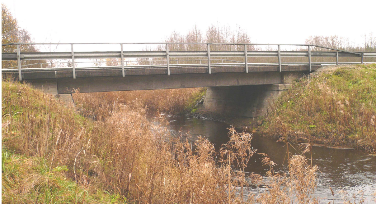
Foto 14. Vaade Vardi jõe sillale 51. km – sild ei ole praegusel kujul heaks läbipääsuks, kuid seda võiks kohaldada
