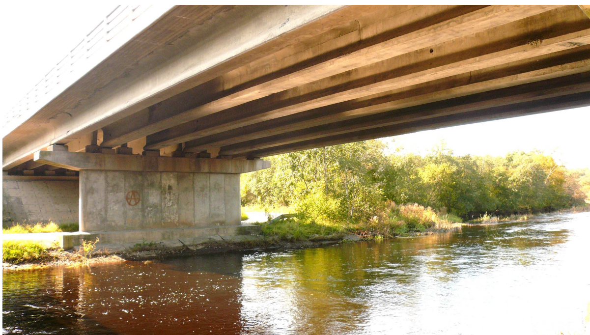
Foto 4. Jõgisoo sillaalune (23. km), kus silla alt kulgeb liiklussõlme ramp ja looduslikku kallastrada ei ole.
