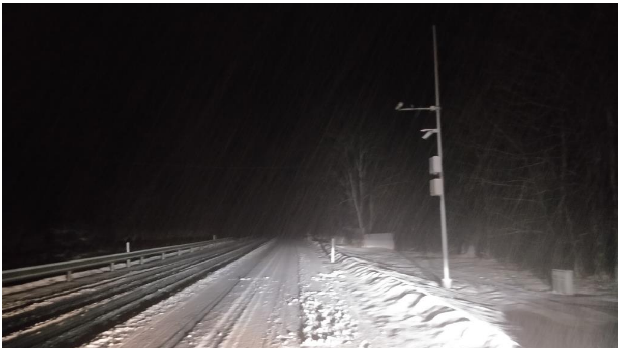
Joonis 19. Teeilmajaam ja teekaamera „Raudoja“ paigaldatuna „Soodla“ teekaamera postile
