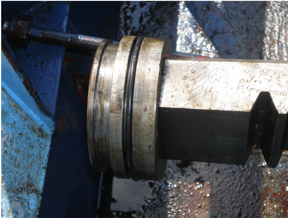
Kraana hüdrosilindril puudub üks mansett
