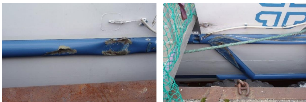
Fotod 2-3 Vasaku parda kaitseprusside vigastused
